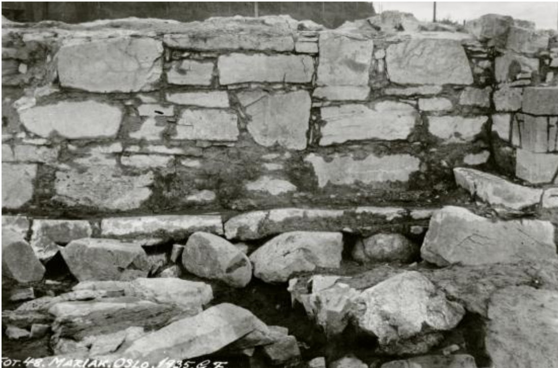
Foto 48. Sett mot sør. Det vestre parti av ytre murliv i nordtårnets nordvegg. Steinansamlingen inn mot murens fundament er en renne som vi også finner motstilt i sørtårnet. G. Fischer, 1935.
