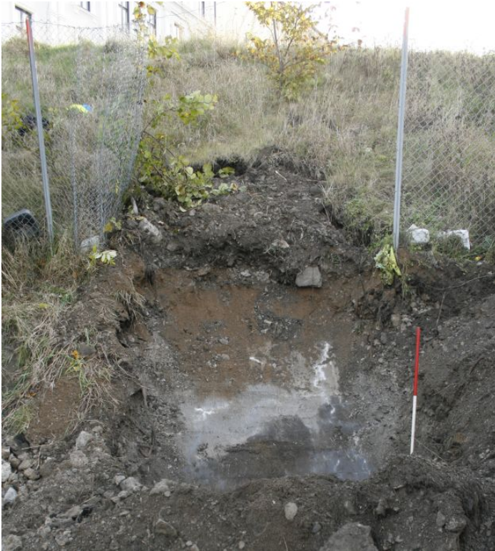
Fig. 9. Grøft 2b med betongkappe fra Loenga bro delvis avdekket. Sett mot øst. Kanslergata 10 skimtes i bakgrunnen til venstre.
