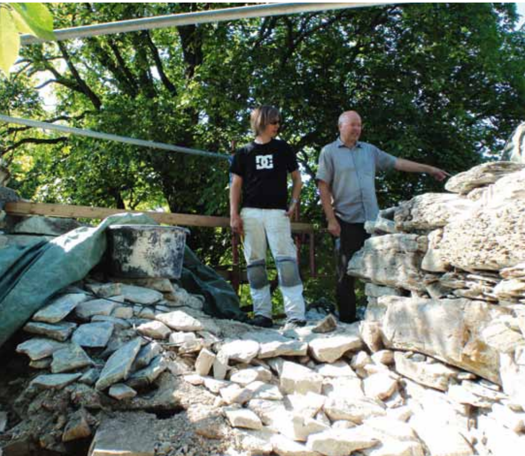
Murar Geir Magnussen og bygningsarkeolog Øystein Ekroll trur knapt sine egne augo då til no ukjende steinveggar frå hertug Skules 1200-tal byrja titte fram. Betong og lausmasse vart tekne vekk, og eit ukjent rom byrja ta form. Foto: Karin Axelsen © Riksantikvaren
