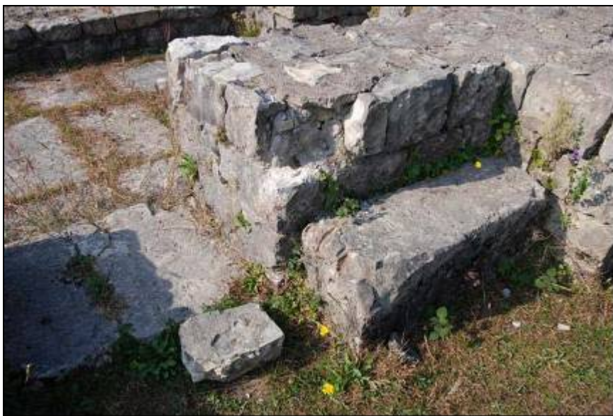
სამეფო აბანოს კედლების ზედა ნაწილი: დაშლილი და ჩამოყრილი ცემენტი. ჩამოვარდნილი ქვის კვადრი
