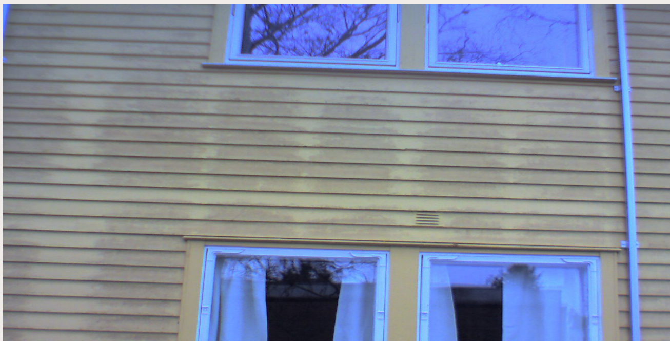
Varmelekkasje gjennom sviller og stendere gjør at panelet tørker raskere, og da trives heller ikke svertesoppen. På de godt isolerte feltene imellom vokser soppen. Foto: © Mycoteam
