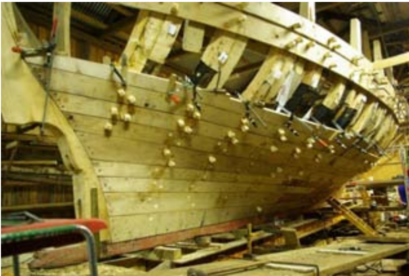
Fra restaureringen av motorskøyten Pål på Bragdøya kystkultursenter (foto: Porto Franco/Vest-Agder fylkeskommune)
