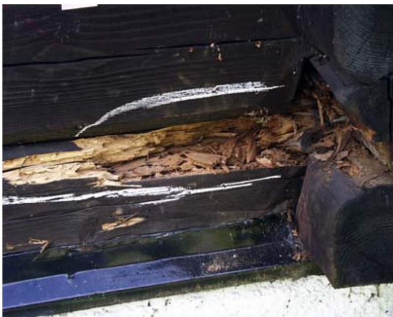
Figur 1. Råteskader. Ofte er det de indre delene av stukkene som er angrepet, mens overflaten er relativt intakt. Dette gjør at råteskader kan være vanskelig å oppdage før skaden har kommet veldig langt. Foto: Mycoteam.
