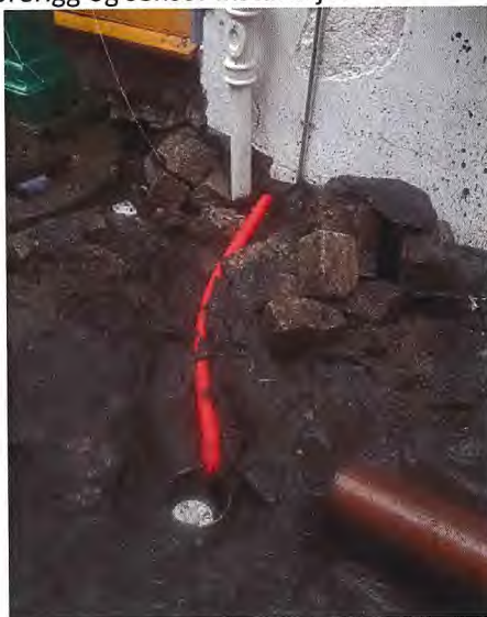
c) Trekkør for sensorkabler
