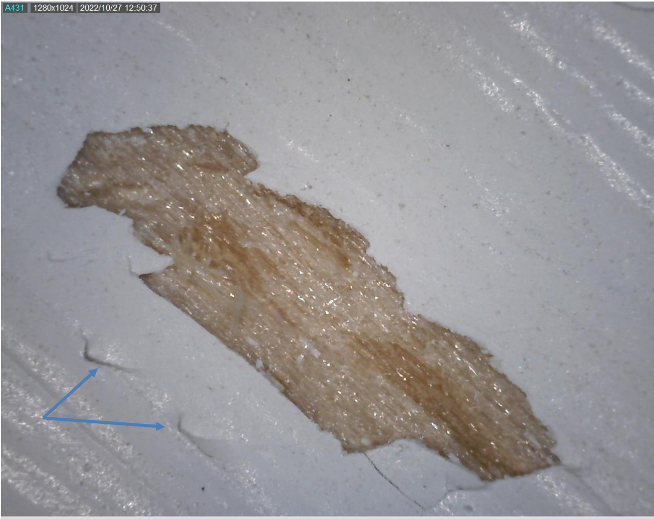
Figur 28. Lunde kirke. Macrofoto av maling på sørveggen. Nytt treverk. Malingen ligger «løs» oppe på treverket. Treverket er kliss vått og bløtt. De blå pilene viser spor etter mine fingertupper, hvor jeg kunne klemme, og flytte malingen fram og tilbake. 160 x. Foto: J. Brønne 27.10.2022.
