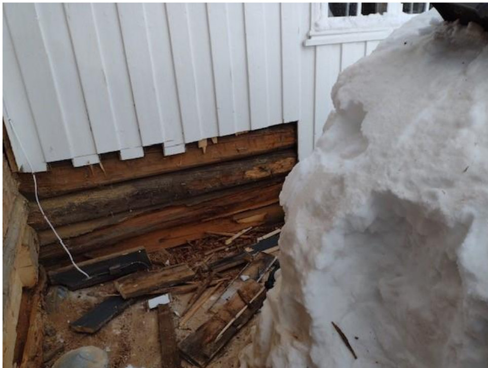
Figur 19. Lunde kirke. Opprinnelig panel er skåret rett av med sirkelsag istedenfor å løsne panelet og gjenbruke det. Detalj av udatert bilde tatt av de som utførte arbeidet, vedlagt i «rapporteringen» av de utførte arbeidene på kirka.
