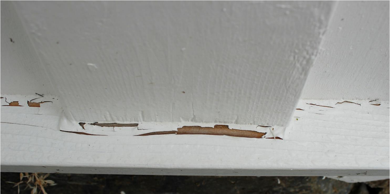
Figur 23. Lunde kirke. Detalj av overgangen mellom nytt panel og den nye sokkellisten. De nye malinglagene har dårlig eller ikke feste til treverket. Spenninger i malingfilmen gjør at malingen skaller opp og faller av. Foto: J. Brønne 27.10.2022.
