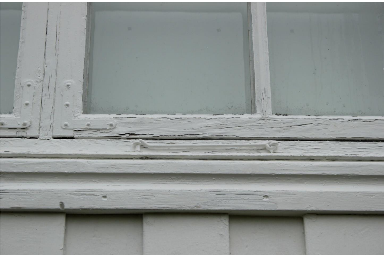
Figur 24. Lunde kirke. Detalj av et av vinduene. Malingen begynner allerede å sprekke og skalle opp. Her er det malt på eldre maling. Foto: J. Brønne 27.10.2022.
