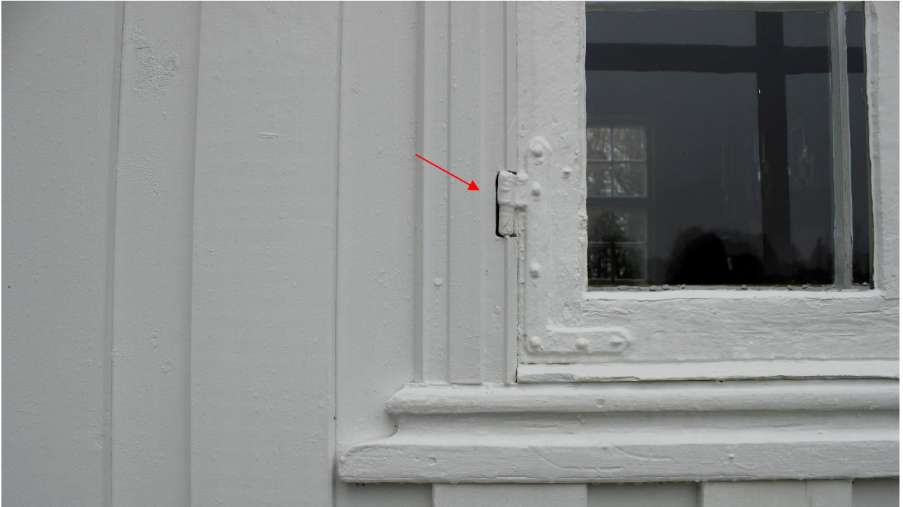
Figur 20. Lunde kirke. I de nye sidegeriktene er det tatt ut spor til hengslene. Det er ikke tatt ut spor slik at vindusrammene kan hektes av. (Rød pil). Udatert bilde tatt av de som utførte arbeidet, vedlagt i «rapporteringen» av de utførte arbeidene på kirka.
