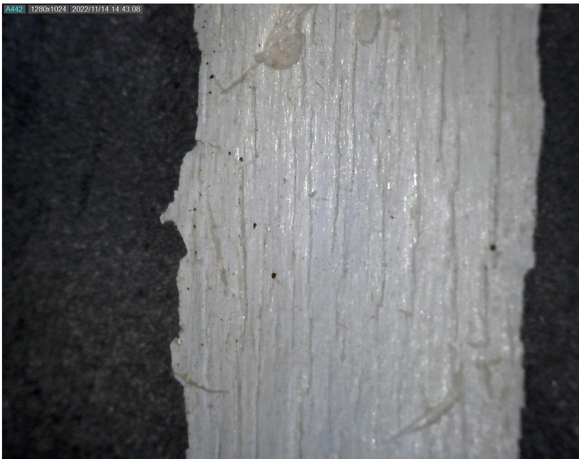
Figur 30. Lunde kirke. Macrofoto av undersiden av den nye malingen. Prøven er tett ut på nordveggen. Vi ser tydelig teksturen i overflaten i treverket som malingen har blitt påført. Vi ser ingen spor etter treverket. Det betyr at den nye akrylmalingen ikke trenger ned i trestrukturen og fester seg, men legger seg som en «plastfolie» på overflaten. 260 x. Foto: J. Brønne 14.11.2022.
