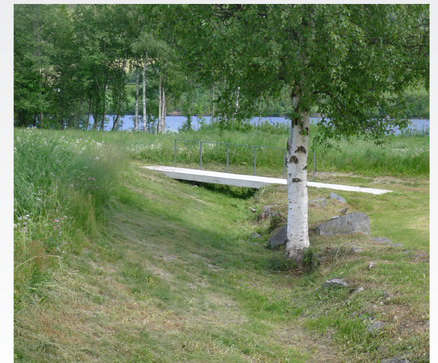
Ny rampe «svever» over kirkegårdsmuren, inn på kirkegården. Handløperen er knapt synlig. Arkeologisk utgraving (NIKU Oppdragsrapp. 121/2012) måtte utføres før rampe kunne støpes, på grunn av en utstikkende stein i muren. Juni 2015.
