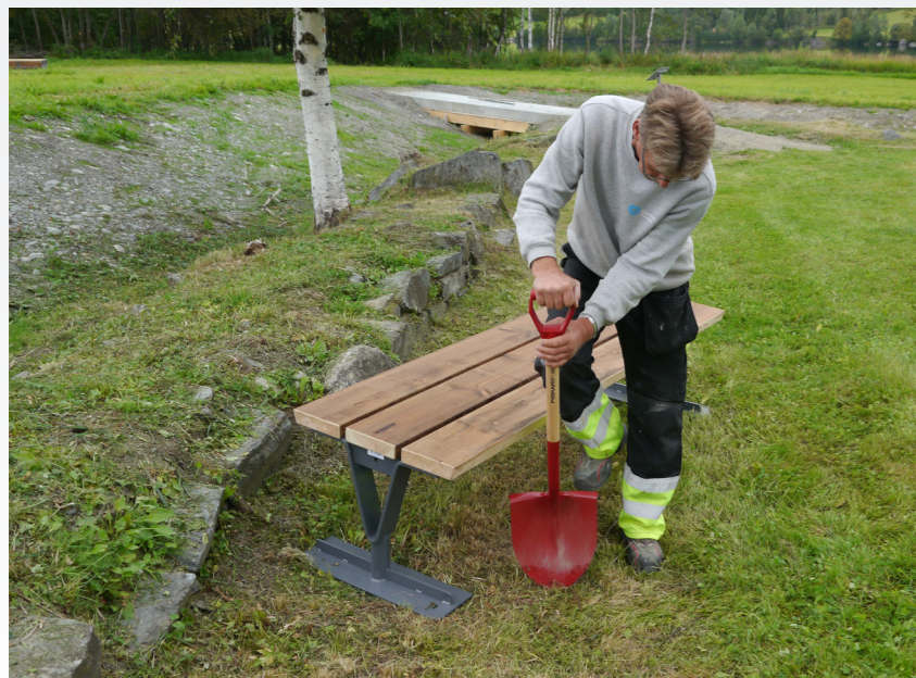
Nedsetting av benk innenfor kirkegårdsmuren. Et spor for hver fotplate tas forsiktig ut med spade.
