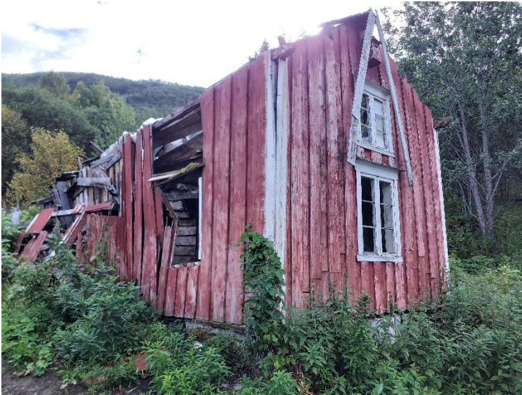
Figur 14: Forfall grunnet manglende vedlikehold kan være en langsom prosess. Denne bygningen har vært vurdert som sterkt truet siden 3. omdrev i 2011. Nå i 5. omdrev har taket kollapse og bygningen anses som tapt.. Foto: HT/ASPLAN VIAK 2021 (19023105009).
