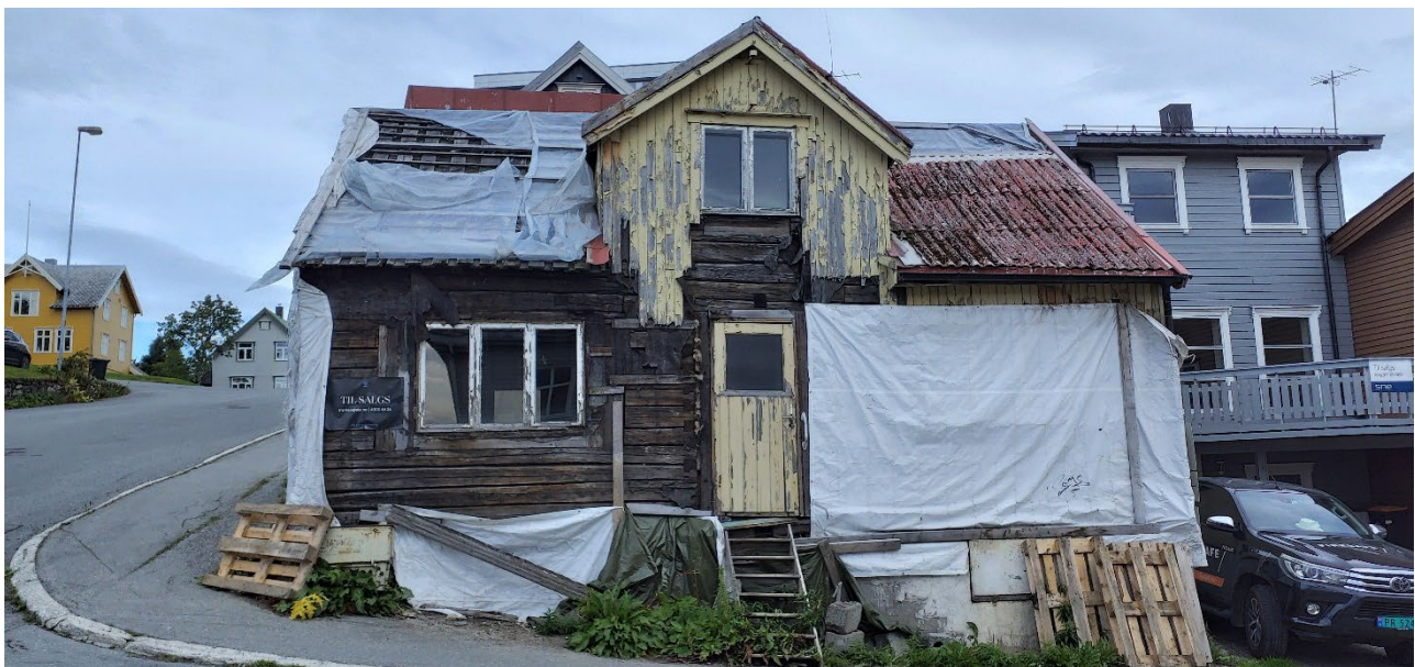
Figur 23: Endringer i tilstanden fra truet til sterkt truet er glidende. Her en bolig som er vurdert å være truet.
