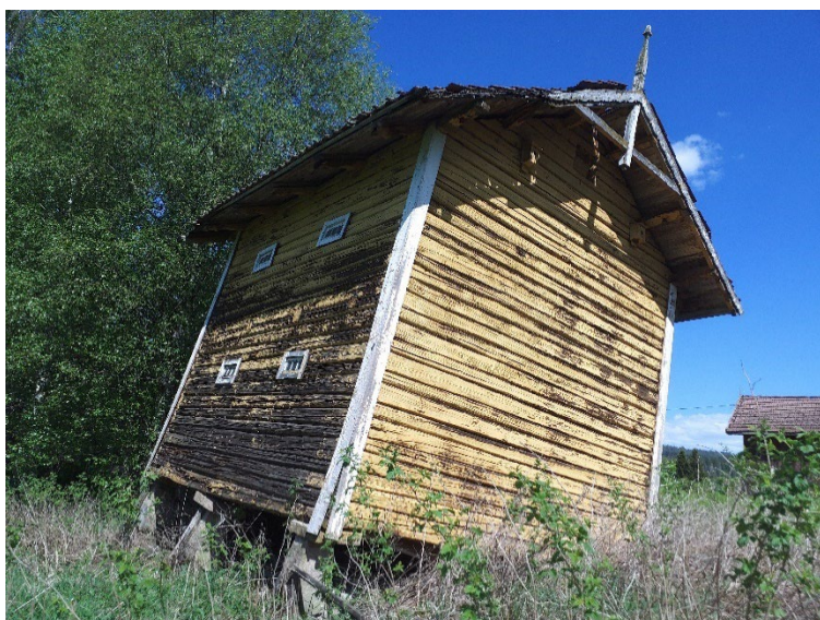
Figur 44: 15 % av mindre uthus i/nær tunet (her et stabbur) er truet eller sterkt truet i 5. omdrev. Dette er dobbelt så høyt som for gjennomsnittet av de undersøkte bygningene i kommunen. Foto: AS/ASPLAN VIAK 2020 (2330007006).
