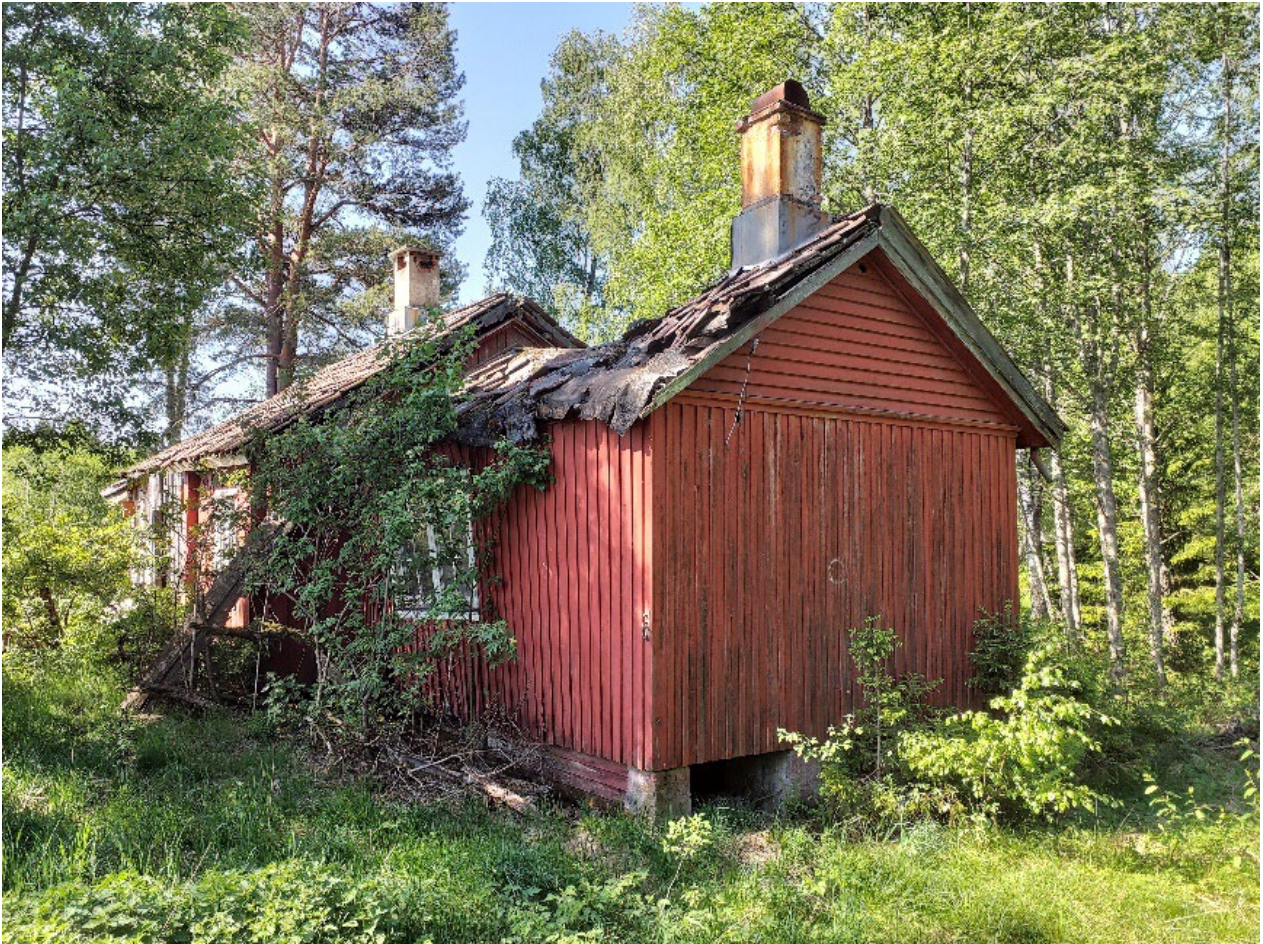
Figur 15: Forfall grunnet manglende vedlikehold kan være en langsom prosess. Denne bygningen har vært vurdert som truet siden 2. omdrev i 2006 og sterkt truet siden 4. omdrev i 2016. Når tak og yttervegger ikke lenger holder snø og regn unna ansees bygningen som sterkt truet, og omfattende tiltak må snarlig settes i verk for å unngå at bygningen går tapt. Foto: HT/ASPLAN VIAK 2021 (2330012012).
