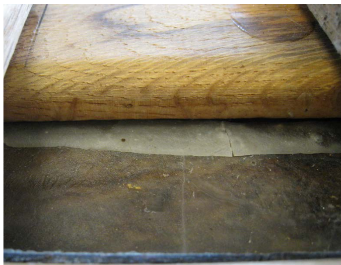
Bilde 4. Bildet viser rester av voks som ligger under en feielist i parketteringen.
