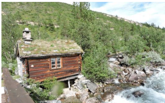
Kvernhuset på Jenstad før tiltaket – rester av dammen sees opp frå elva til høyre. Foto: Kari Marie Jenstada
