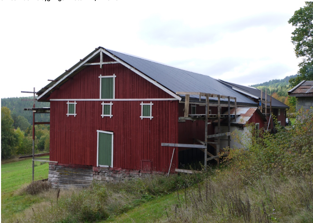
08210008117: 42 % av de større SEFRAK-registrerte driftsbygningene er endret i 3. omdrev. For 27 % dreier det seg kun om overflateendringer og vedlikehold, slik som her, hvor taktekingen er fornyet. Foto: ÅD/NIKU 2014
