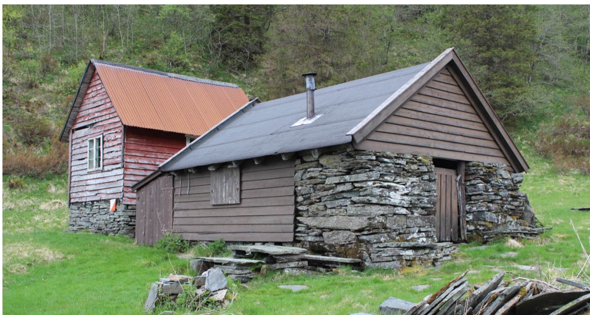
12420004032: Utmarksbygningene er spesielt utsatt, ettersom seterdriften er marginalisert. I Samnanger er det høyest tapsandel i denne bygningsgruppen i 3. omdrev (10 %) og høyest akkumulert tap (46 % mot 31 %). Foto: ÅD/NIKU 2014
