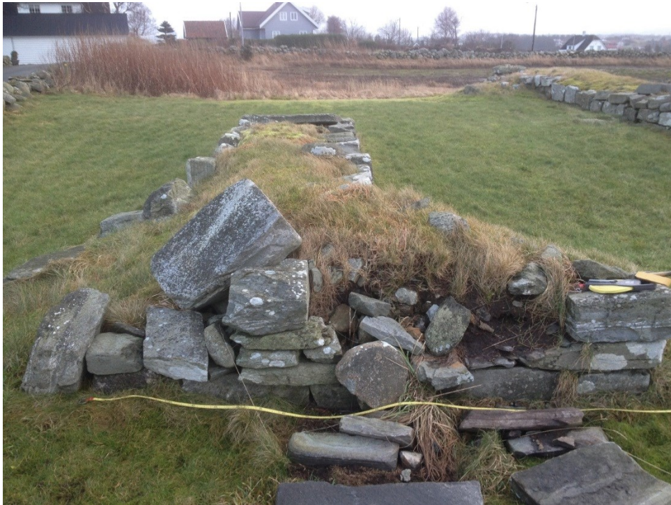
Fig. 6. Kirkeruin på Viste i 2014, sett fra vest. Kollaps av den vest vegg som fører til at murkjernen blir eksponert og uten støtte.
