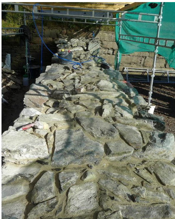
Figur 5. Ny toppdekning med eksponert murkjerne av kalkmørtel og bruddstein (foto: Byantikvaren 2014).
