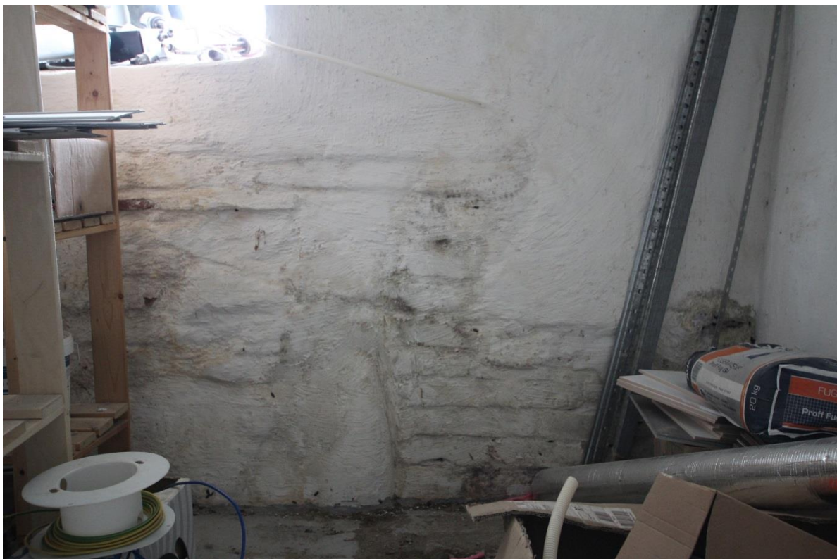
Fig.6 Foto av murparti i kjelleren i Maskinistforeningens hus (vestmur, indre murliv). I muren sees både bruddstein og teglstein om hverandre. Teglsteinene har ikke middelaldersk format. Foto tatt 25.04.14 mot vest.
