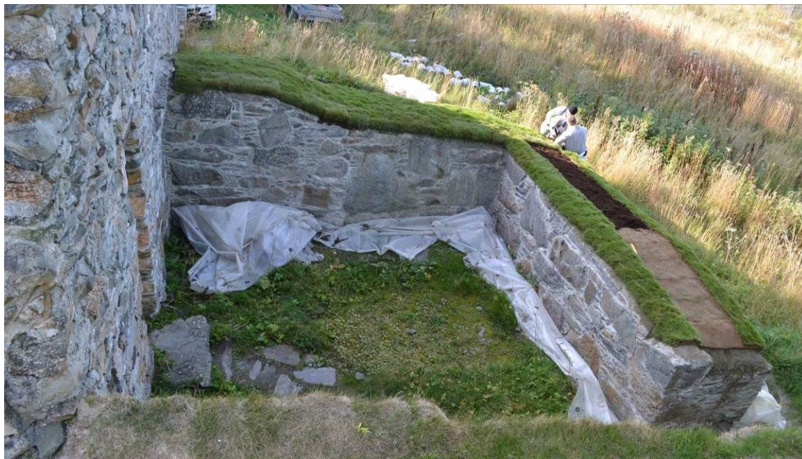
Foto 20050723_029 Vestre del av sakristi under arbeid med legging av ferdigplen på fuktsikring.
