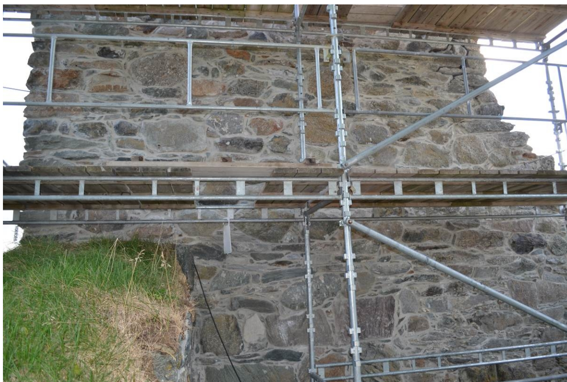
Foto 20050723_027: Vegg i østre sakristi ferdig spekket til det området som ble bestemt demontert. Murverket hadde store hulrom og disse ble fortløpende fylt med pinningsstein og mørtel.
