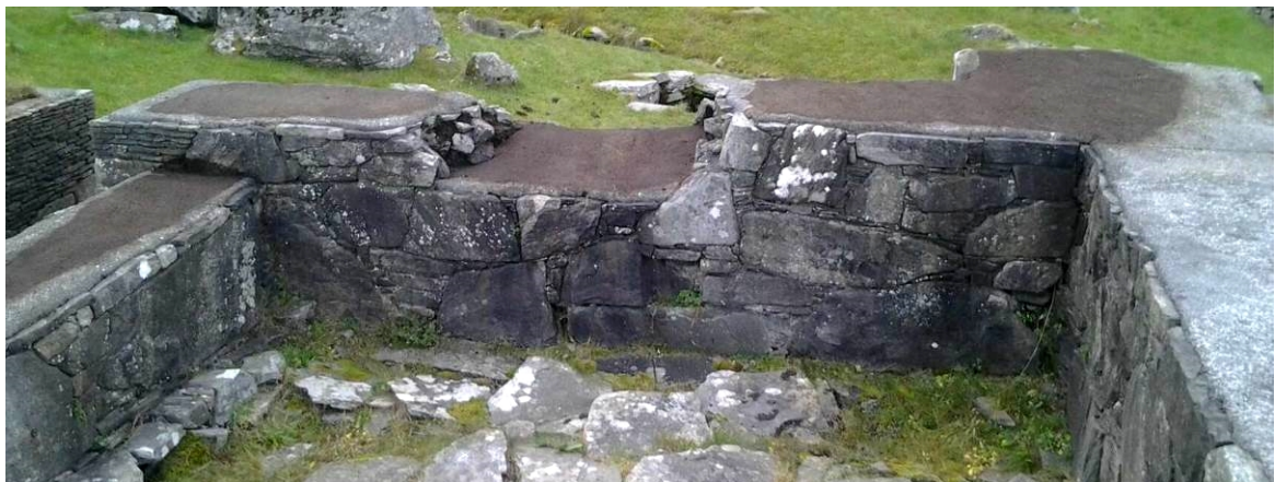
Foto IMG_0734: Fjernet torv på toppdekke i dagrom. Mørke partier på toppdekket er fukt/humus etter torv som lå direkte på muren.
