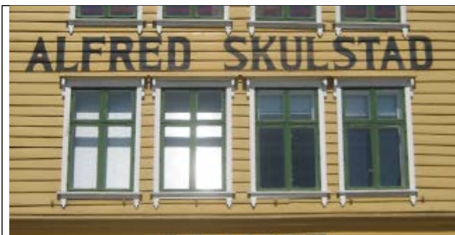
Bygning 1A. Vinduene i 2.etasje. Fra venstre vindu 2A, 2B, 2C og 2D
