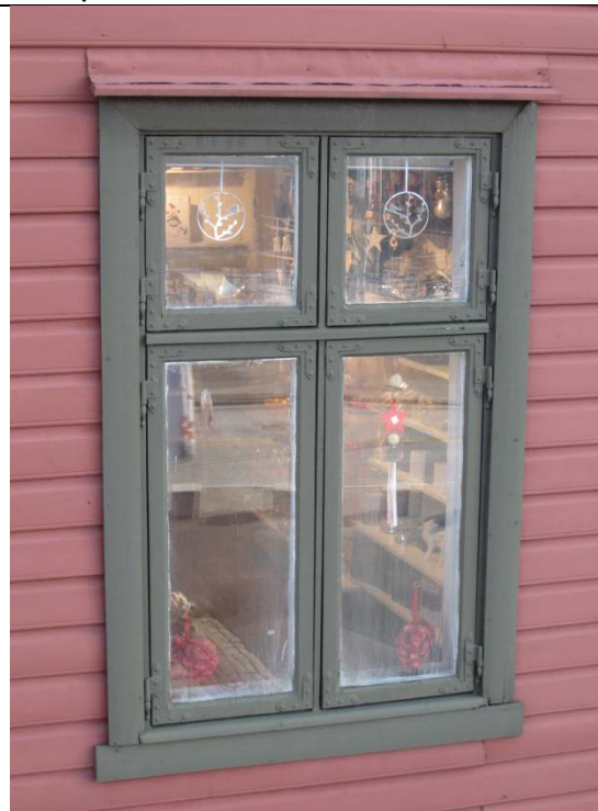
Vindu i tredje etasje(3A). Foto:NIKU
