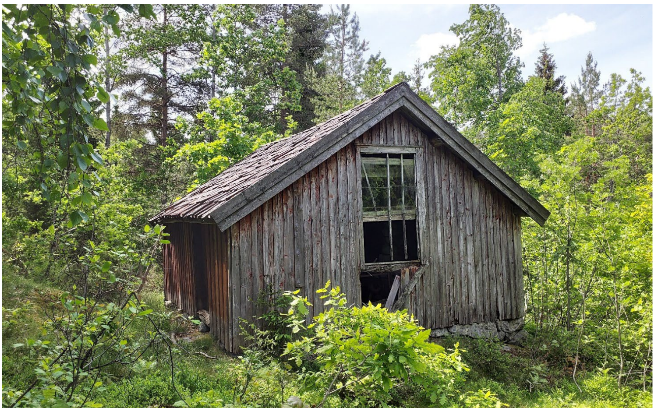
Figur 21: Bygninger som er i teknisk dårlig tilstand på grunn av manglende vedlikehold over tid vurderes som truet. Ofte er dette bygninger som har gått ut av bruk, som for eksempel denne smia. Foto: HT/ASPLAN VIAK 2020 (9110104018)
