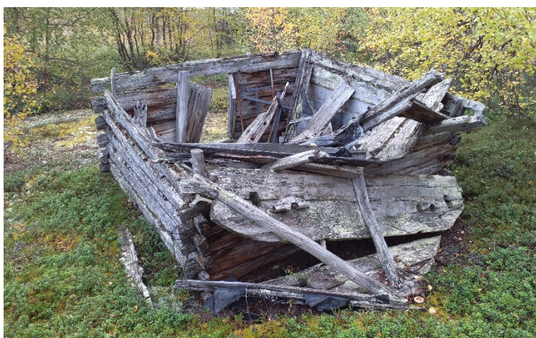
Figur 8: Dette stabburet ansees som tapt i 5. omdrev. Forfallet har sannsynligvis kommet for langt til at bygningen kan reddes. Foto: HT/ASPLAN VIAK 2020 (20110004026)
