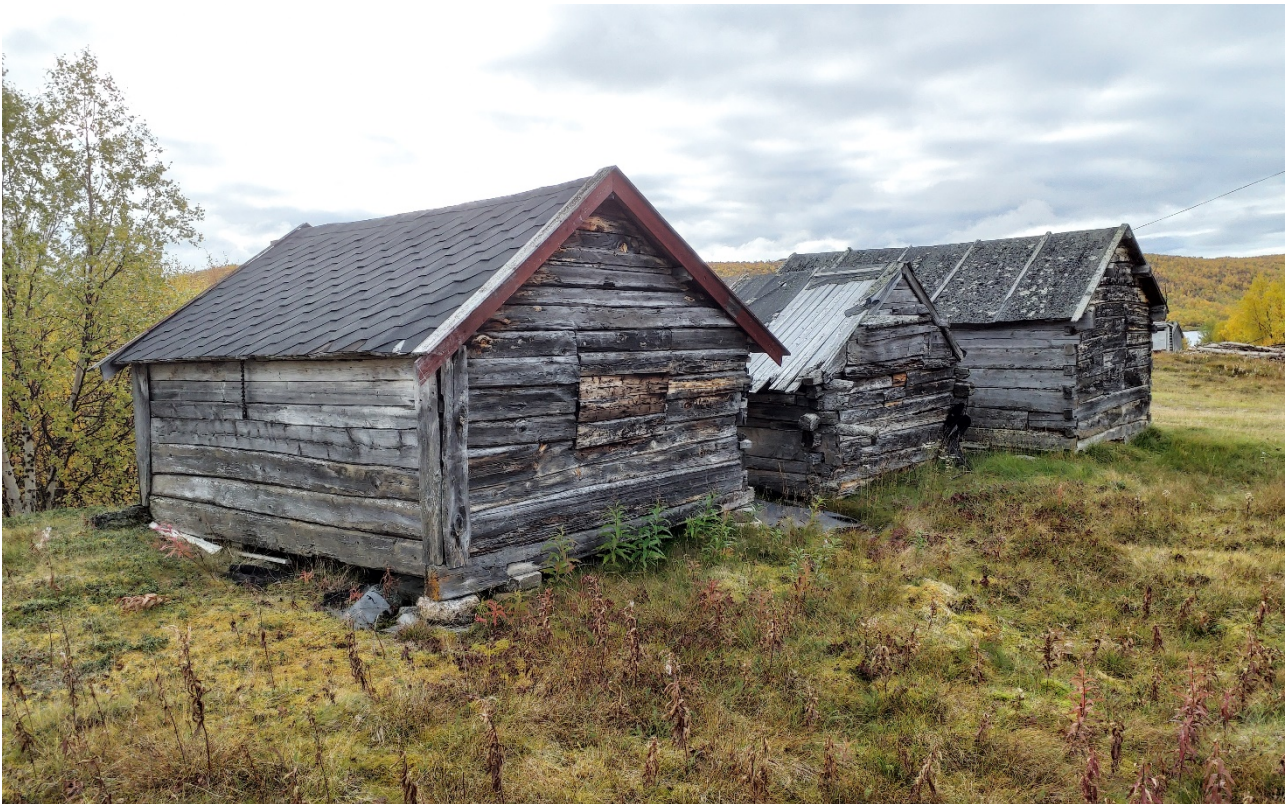
Figur 10: Tre stabbur på rad. Det nærmeste stabburet har fått ny takteking siden forrige omdrev, noe som tilsvarer en liten endring (c). Med nytt, tett tak har bygningens tilstand har gått fra å være truet til å vurderes som intakt. De to bakerste bygningene vurderes som truet. Foto: HT/ASPLAN VIAK (20110004019)
