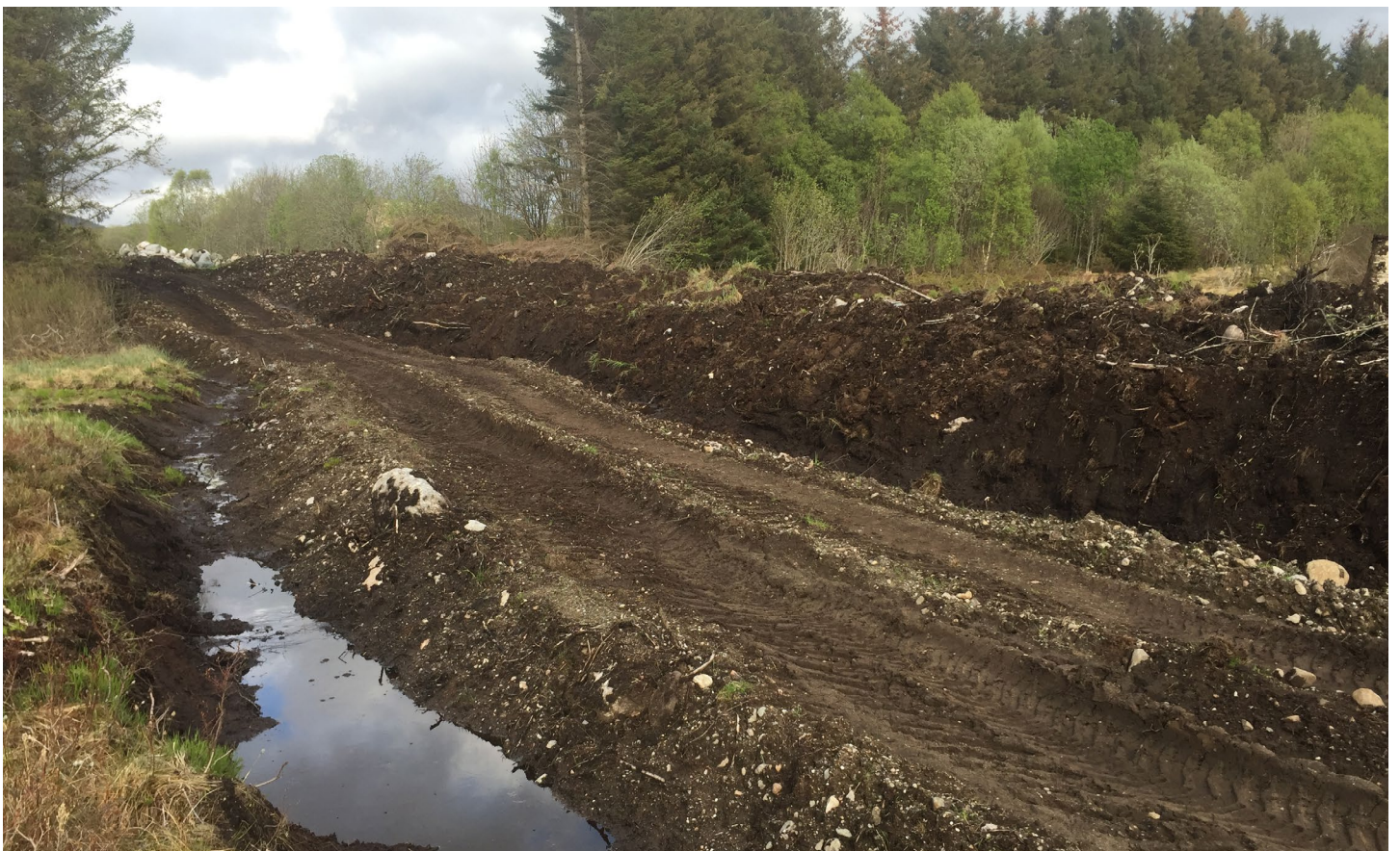
Figur 5-12. Fræna id 123429 skadet av jordbruksvei
