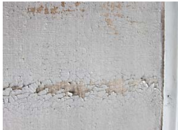
Opp- og avskallinger i malingslaget
