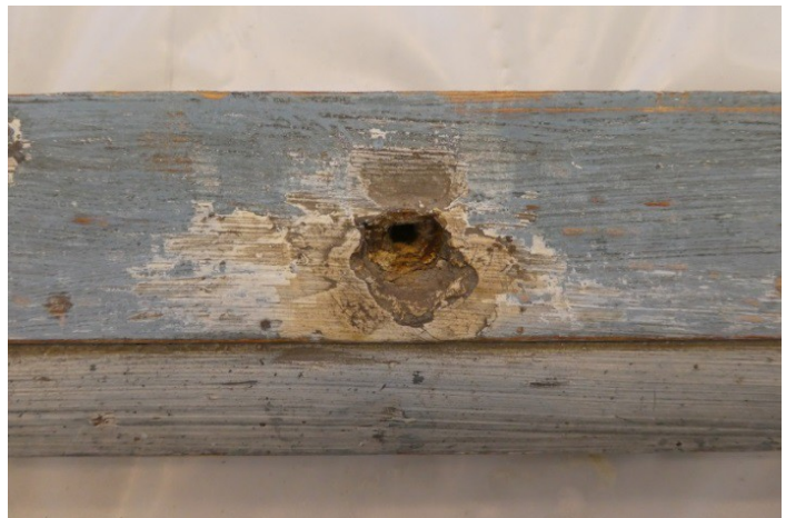
Figur 26. Kitting over skader rundt spikerhodet på brystningslisten. i
