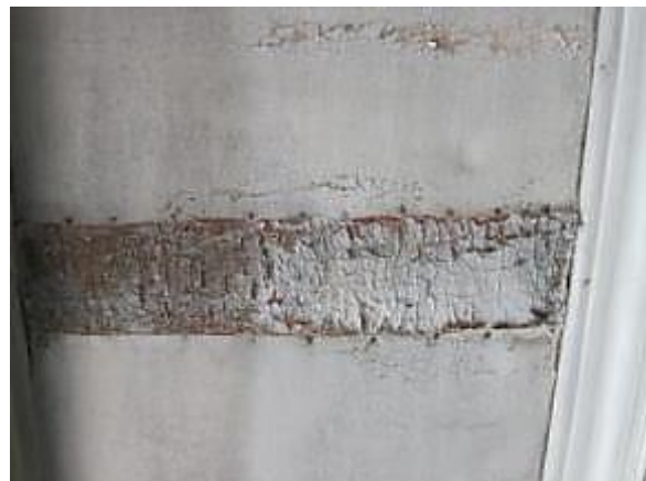
Tettvevet lerret har rød grunning og grå maling som skaller av
