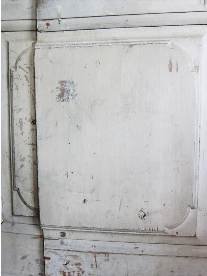
Figur 25. Skader på speilfeltet på den skjulte døren på østveggen. Det har tidligere blitt gjort noen avskrapinger gjennom overmalingen, trolig for å se hva som lå under. Det er delvis skrapet ned til original dekor og delvis ned i treverket. En figur kan tydelig skimtes gjennom malingslaget.
