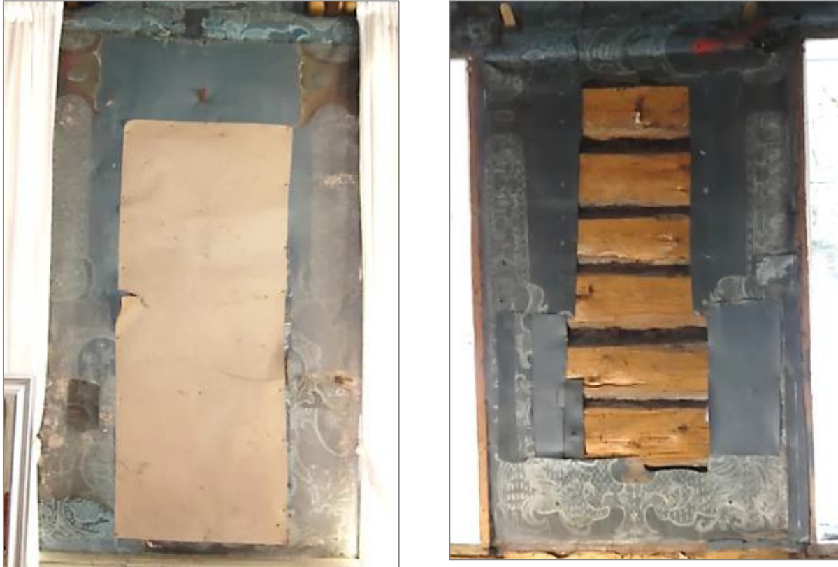
Figur 23. Partiene mellom vinduene på sydveggen (delvis dekket med papp) og på vestveggen (pappen er fjernet). Her har det hengt speil, og tapetbiter bak speilene har blitt skåret ut og brukt som reparasjonslapper.
