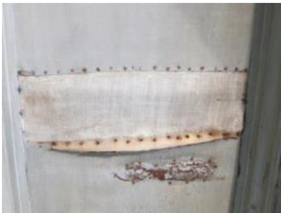
Tynt, hvitmalt reparasjonslerret, er løs på den ene siden
