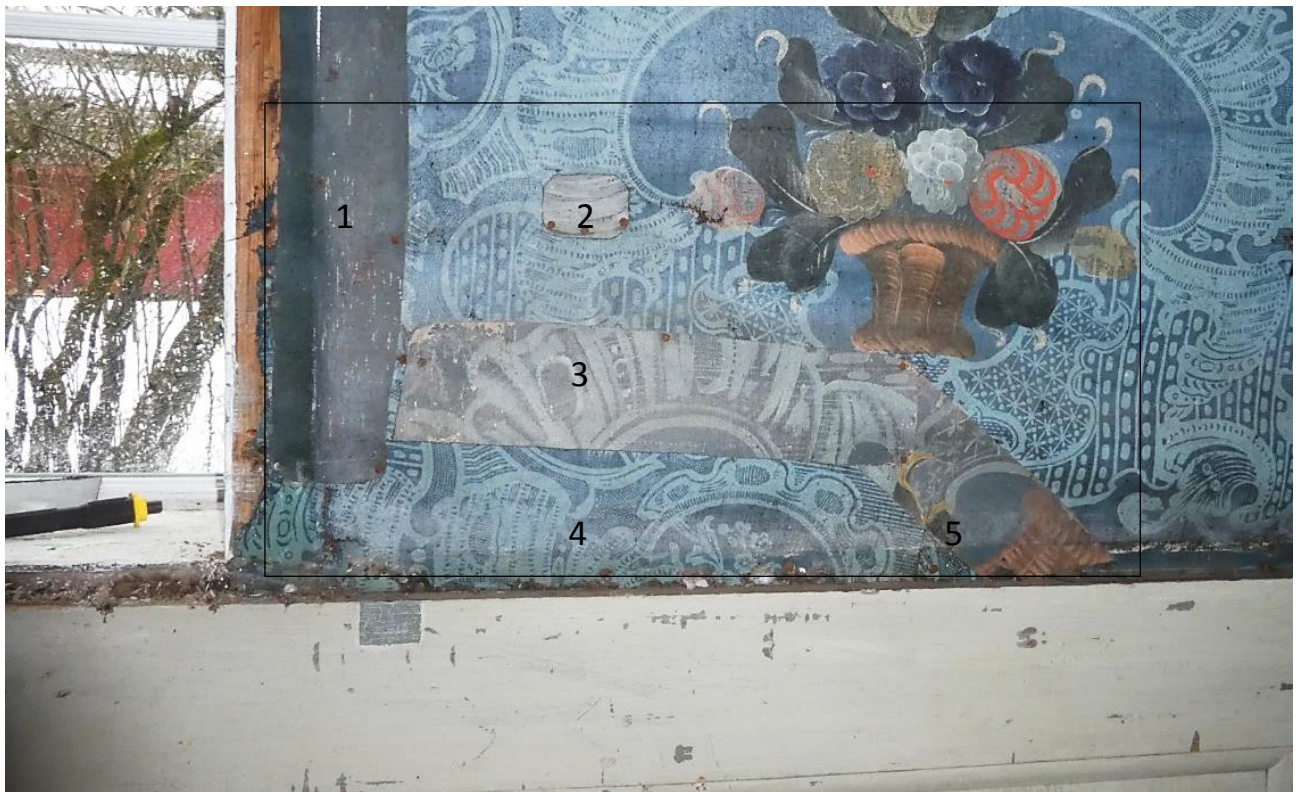
Figur 55. Sydvegg, vest for vestre vindu. Skader i tapetet var dekket med 5 lapper. Lappene 1-3 var fra det sekundære lerretet fra området mellom vinduene. Lapp 4 og 5 er lapper av originaltapetet.
