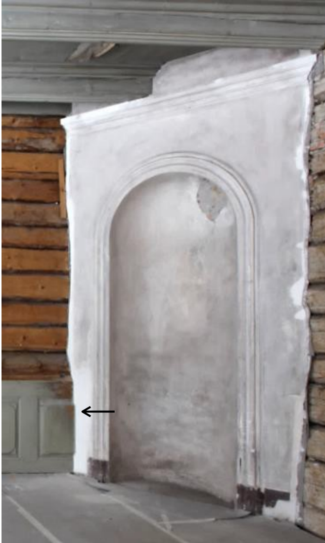
Figur 20. Brannmurnisjen i nordøstre hjørne er murt over ca 50 cm av brystningen.
