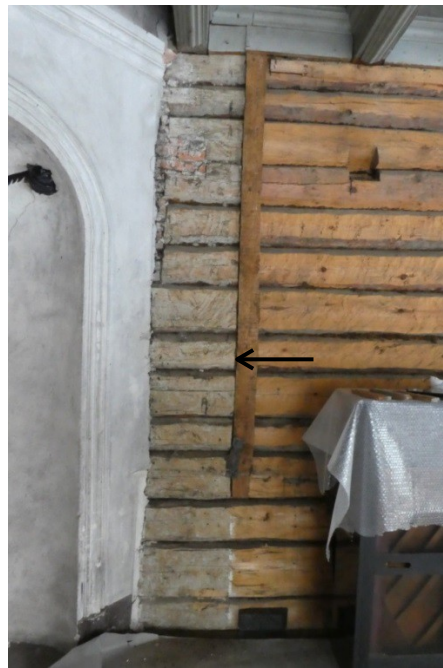
Figur 22. Etter demonteringen av tapetet på østveggen. Pilen markerer hvor bred den opprinnelige brannmuren var.
