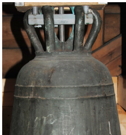
Ill. 17: Eksempel på klokke fra middelalderen hvor hengjernet til kolben er rustet bort, og hvor den nye kolben er montert med en gjennomgående bolt som festes ovenpå opphenget. I dette tilfellet har kronen en åpen sentralbøyle, slik at den gjennomgående bolten blir svært synlig og skjemmende. I klokker med åpen sentralbøyle skal denne måten å montere kolber på ikke benyttes. FOTO: TERJE DE GROOT.
