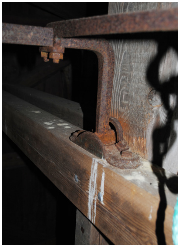
Ill. 12: Tysvær kirke, Rogaland. Knivlager. Detalj av balanseringeapparatet. Her ser vi «kniven» som vagger i en stålpanne, med sikkerhetsbøyle over. FOTO: TERJE DE GROOT.
