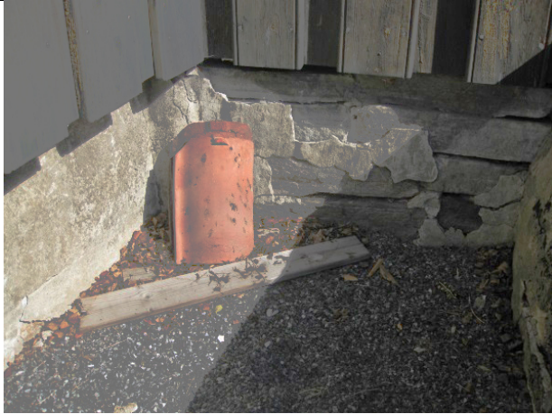
Sydvegg, østre del . Mellom trapp på sydvegg (koret) og søndre korsarm. Vann ser ut til å samles på trappa og renner ned på muren.
