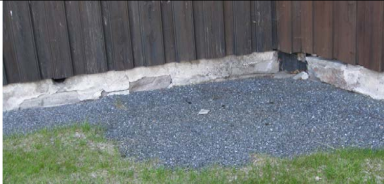
Sydvegg. Hjørnet mellom østdel av sydvegg og søndre korsarm. Stolpen/Staven 6 står utildekket. Kort avstand mellom grusnivå og stolpe/stav. Murpussen faller av. Sementholdig puss.
