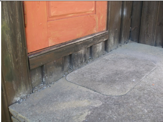
Trapp inn til sakrsti. Det er ikke mellomrom mellom trappehelle og vegg. Fukt blir stående mellom trapp og veggen. Dette kan på kort sikt bety en belastning for panelet, på lang sikt en fuktbelastning for konstruksjonen bak panelet.
