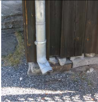
Nedløp vest på sydvegg. Nedløpet er klemt flatt i «knekken» nede.
