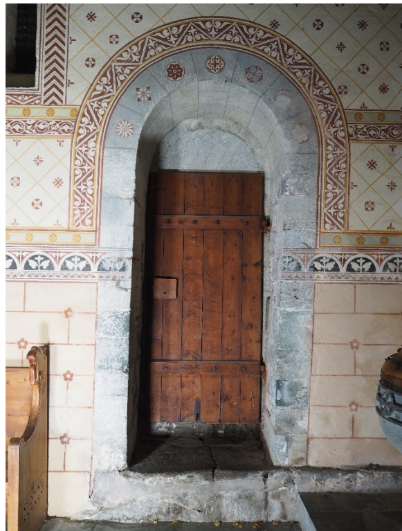
Figur 22: Skip. Søndre portal. Mindre skader i malingslaget.
