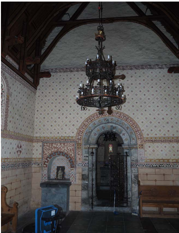
Figur 15: Skipets østvegg med korbuen. Området har kun mindre skader i nedre veggavsnitt.
