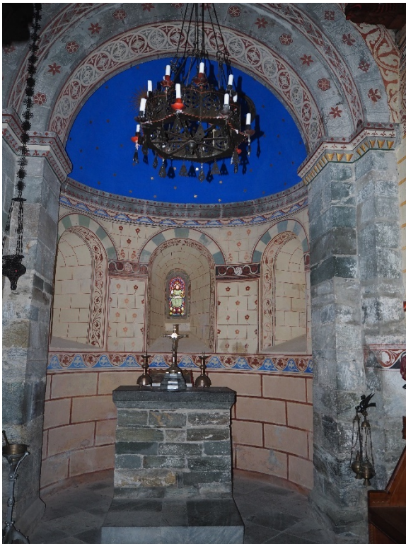
Figur 25: Korapside. Fuktskader i nedre del av veggen.
