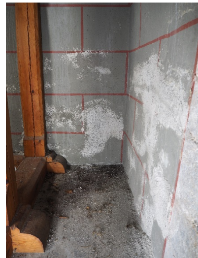
Figur 14: Våpenhus. Sydvegg, under trappen. Avskallinger, løs maling og saltutfellinginger.
