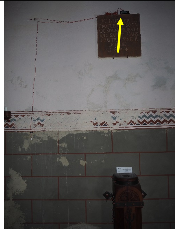
Våpenhus. Thermofox «A»
