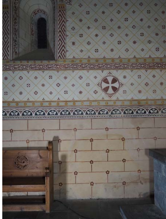
Figur 20: Skip. Nordvegg, østre veggdel. Mindre fuktskader i nedre del av vegg.
