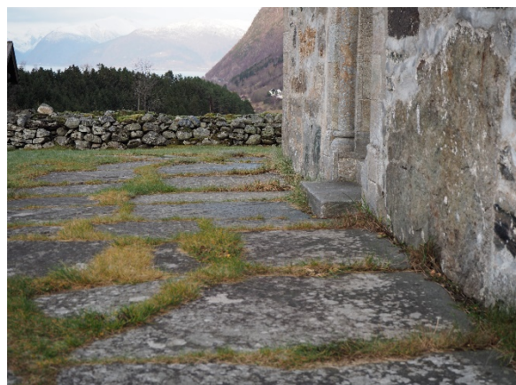
Figur 4: Uteområde foran vestre inngang. Gress vokser mellom hellene og langs med kirkens sokkelsone.
