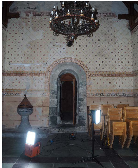
Figur 16: Skipets vestvegg med steinportal og gjennomgang mot våpenhuset. Området har omfattende skader på søndre, nedre del (i bilde til venstre).
