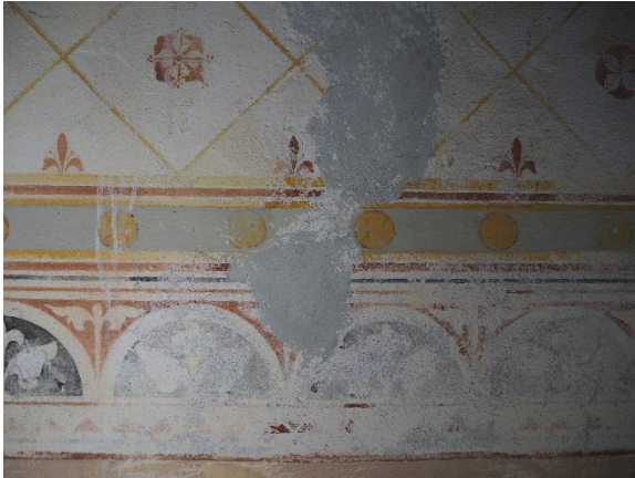
Figur 6: Detalj fra skipets vestvegg. På en tidligere pussreparasjon har malingen komplett gått tapt.
