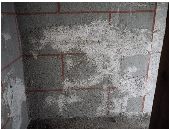
Figur 8: Detalj fra våpenhusets østvegg. Fuktrskjolder i sokkelområde.
