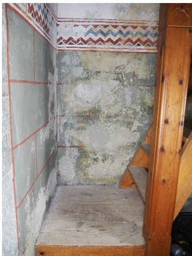
Figur 12: Våpenhus. Sydvegg, østre nedre del. Avskallinger, løs maling og fuktroser. Originaldekor er bevart.
