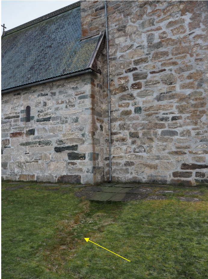
Figur 5: Nordfasade. Avløpsrenne mellom skip (t.v. i bilde) og tårn fører vannet over hellene og ut i plenen, som vises tydelig i vegetasjonen (pil).
