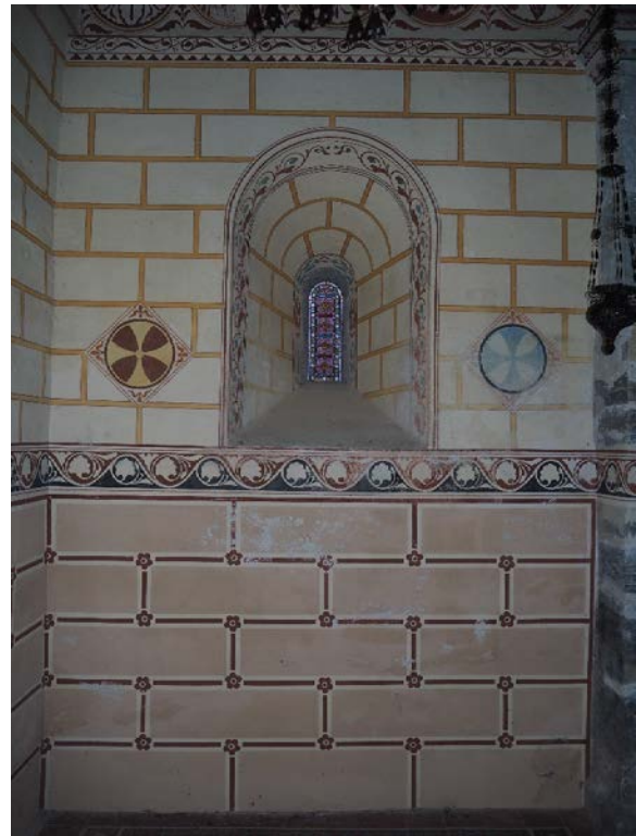
Figur 26: Kor. Nordvegg. Flere skader i malingslaget.
