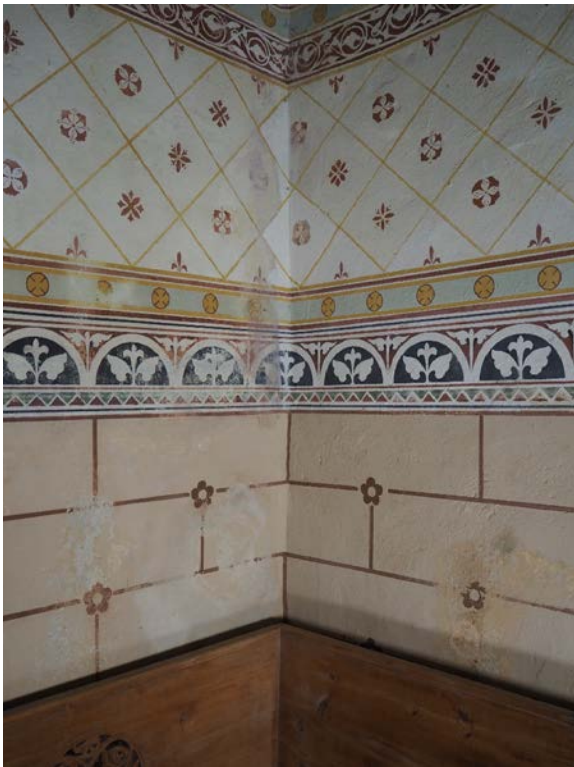
Figur 21: Skip. Syd-østre hjørne. Fuktskader i nedre del.
