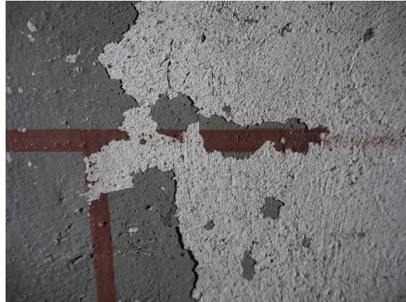
Figur 7: Detalj fra våpenhusets veggdekor. Løse malingsflak som holder på å drysse ned. Deler av dekoren har allerede gått tapt.
