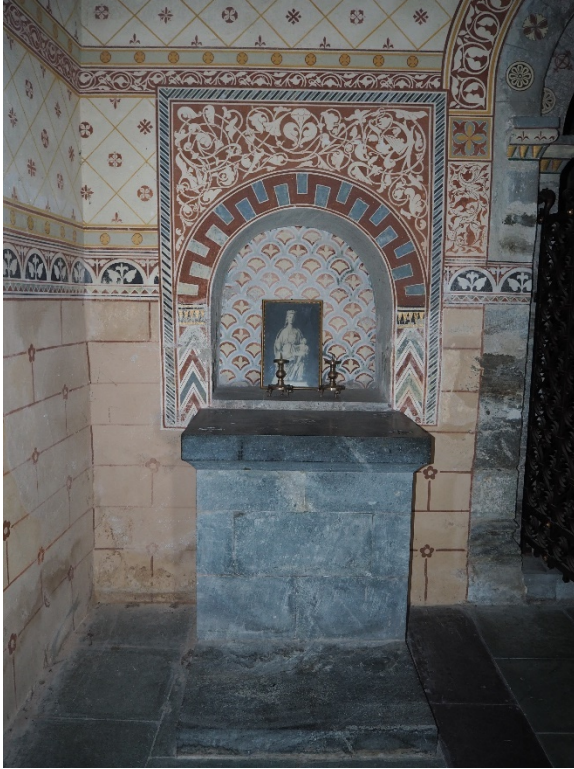
Figur 31: Skip. Østvegg, nord for korbuen. Sokkelområdet har moderate fuktskader. Tilstand 2016.
