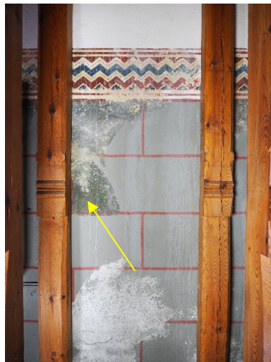
Figur 13: Våpenhus. Sydvegg, under trappen. Avskallinger, løs maling og fuktroser. Originaldekor er bevart (pil).
