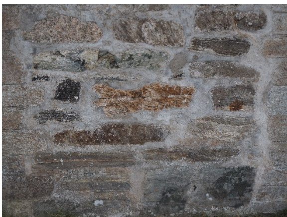
Figur 3: Detalj fra vesttårnets vestfasade. Fugene er spekket med sementmørtel.
