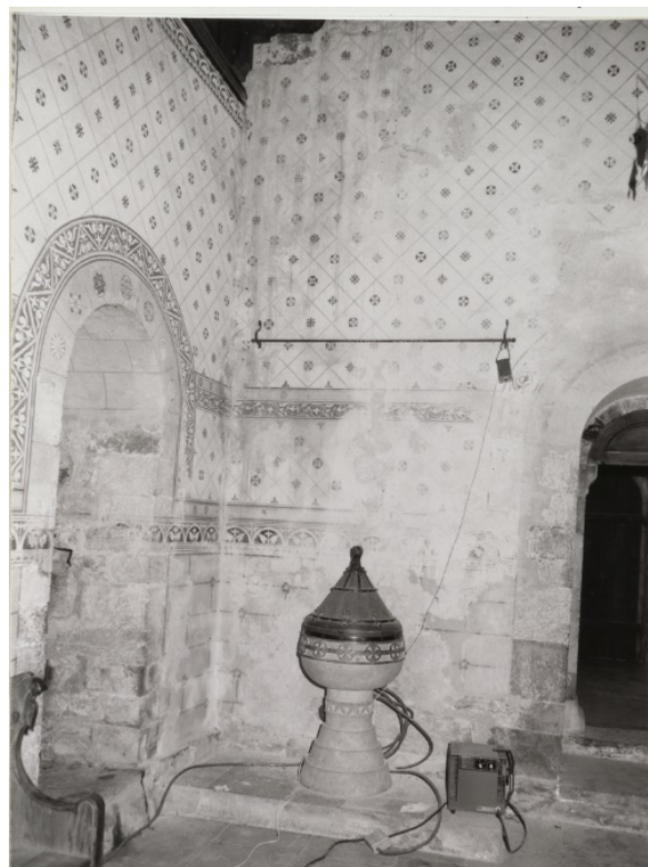
Figur 34: Arkivbilde. Omtrent samme utsnitt som i bilde til venstre. Området har omfattende skader i veggdekoren i nedre veggavsnitt, og man ser rennespor fra en tidligere taklekkasje øverst i bilde. Foto: Lars Hauglid 1986
