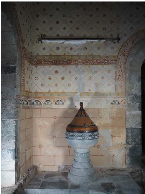
Figur 33: Skip. Vestvegg, sør for portalen. Området har betydelige skader i dekoren i nedre veggavsnitt. Tilstand 2016.
