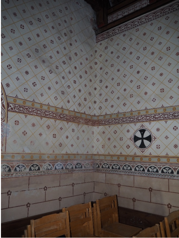
Figur 19: Skip. Nord-vestre hjørne. Enkelte skader i malingslaget.
