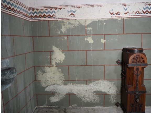
Figur 10: Våpenhus. Nordvegg, vestre nedre del. Avskallinger, løs maling, fuktroser og renner.
