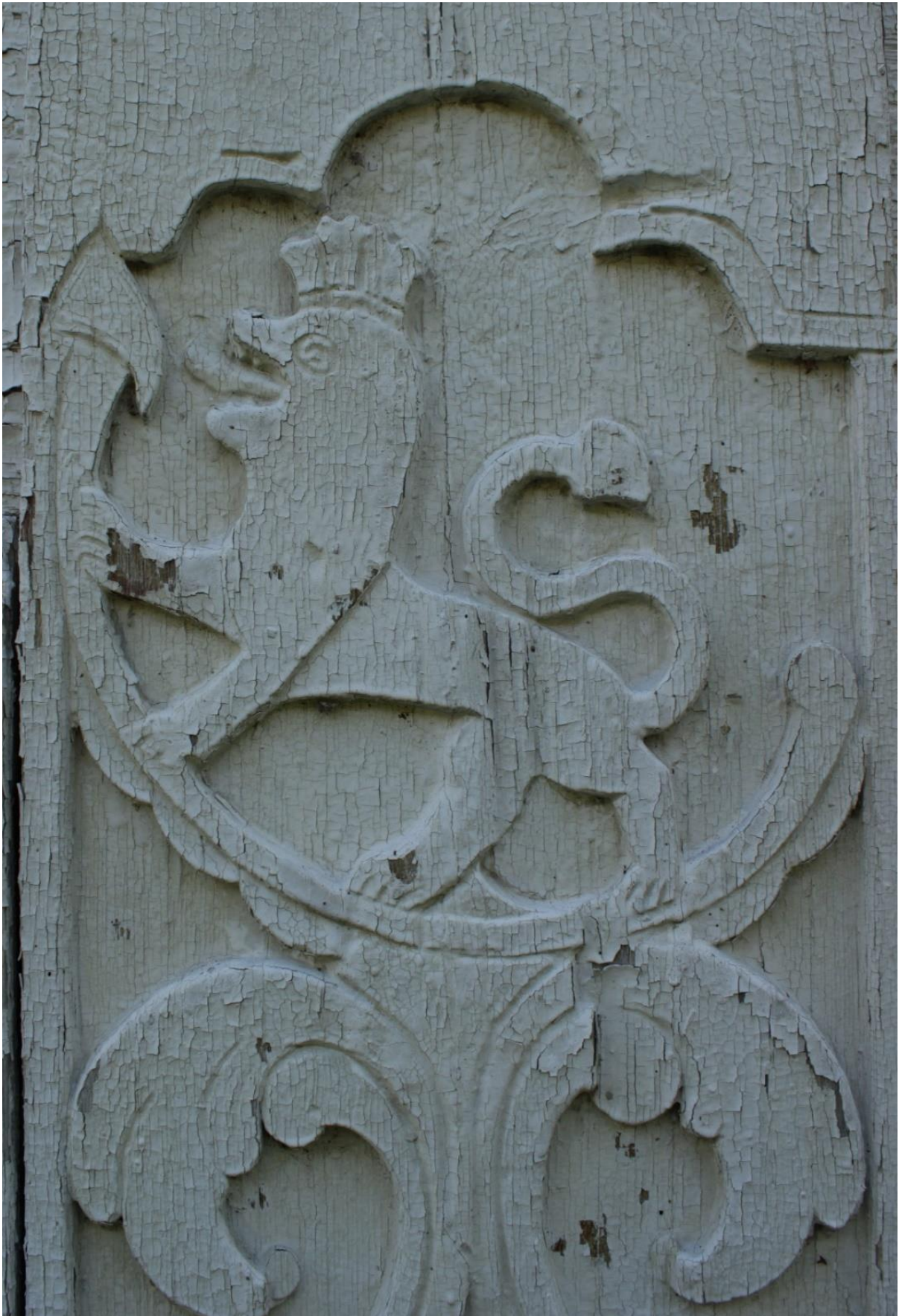
Figur 26. Skjønne, Søre. Detalj av «Den Norske Løve» på nordre dørkarm. Noen opp- og avskallinger i malinglagene, men resten av malingen har meget dårlig feste til underlaget. Foto. J. Brønne. September
