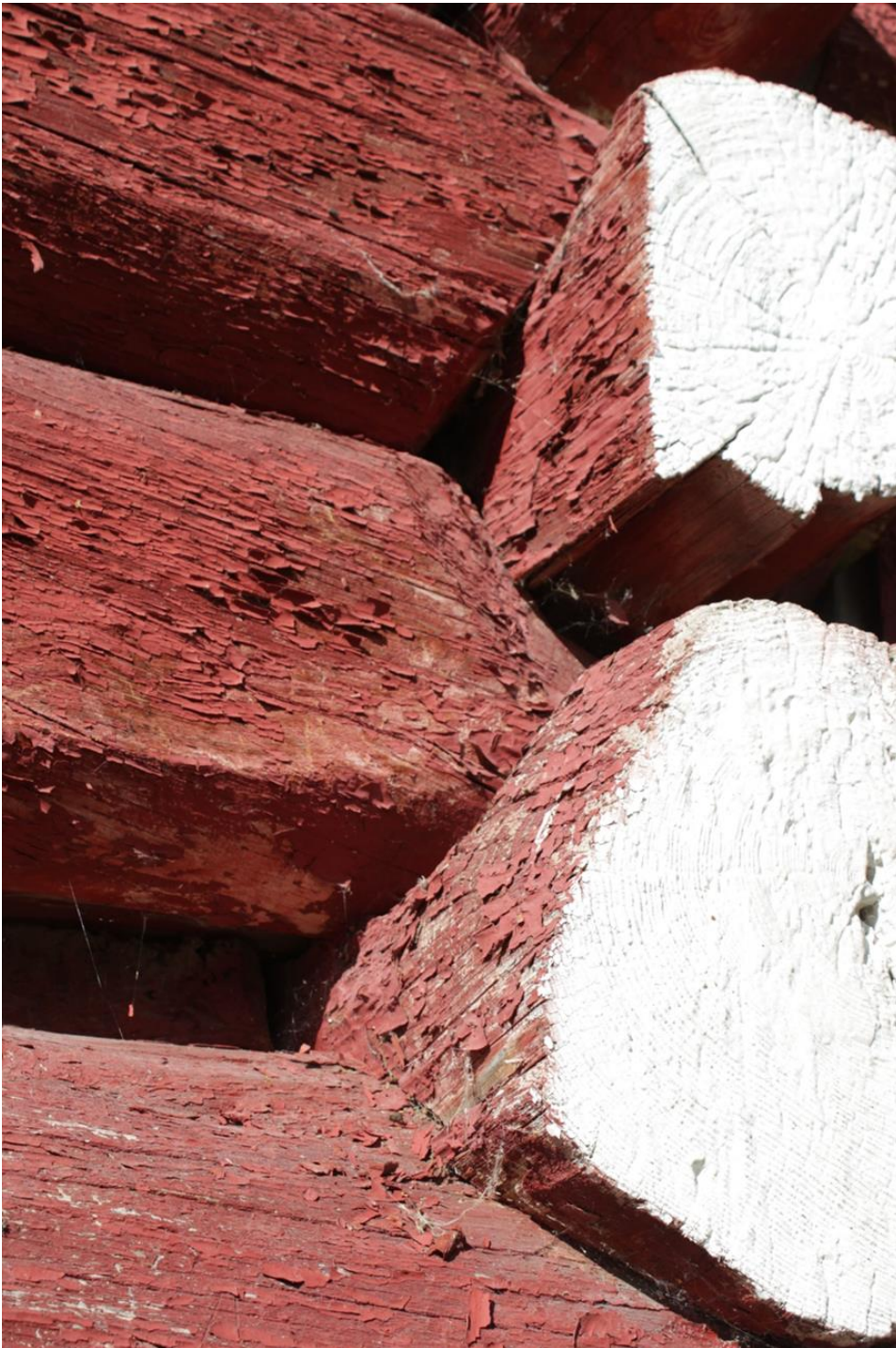
Figur 23. Skjønne, Søre. Detalj av sydøstre nov med tømmerveggen mot syd. Store opp- og avskallinger i flere malinglag. Foto. J. Brønne. September 2017.
