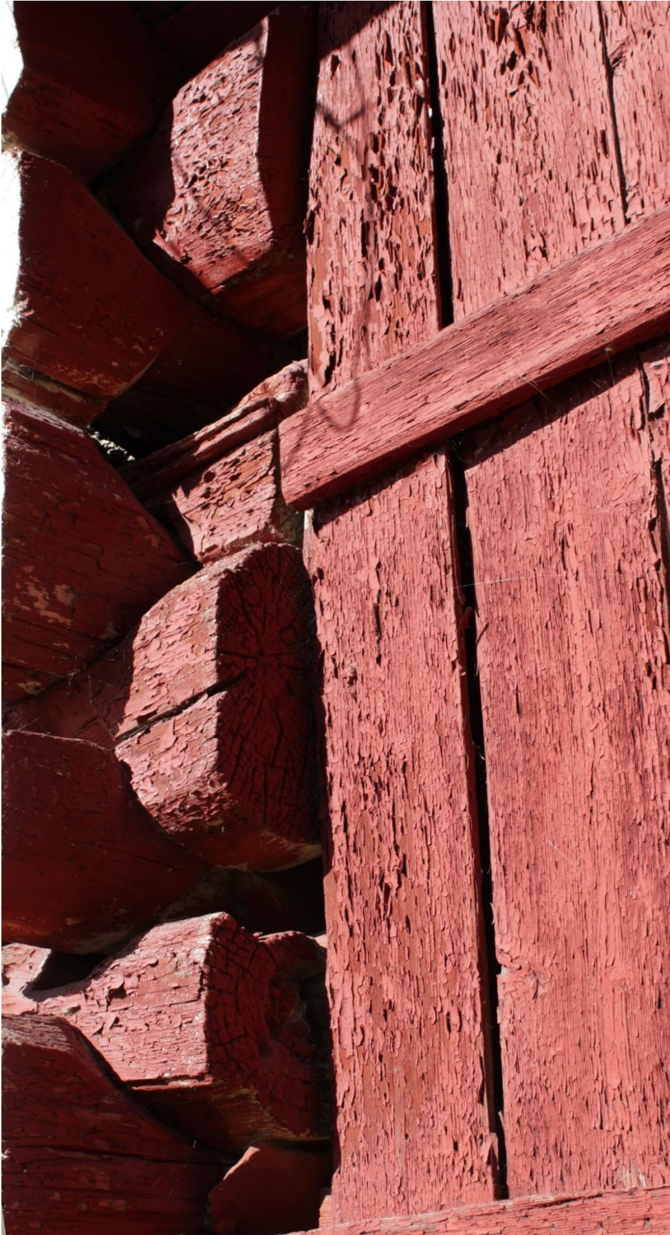
Figur 22. Skjønne, Søre. Detalj av sydøstre nov og tiler i svalgangen. Store opp- og avskallinger i flere malinglag. Foto. J. Brønne. September 2017.
