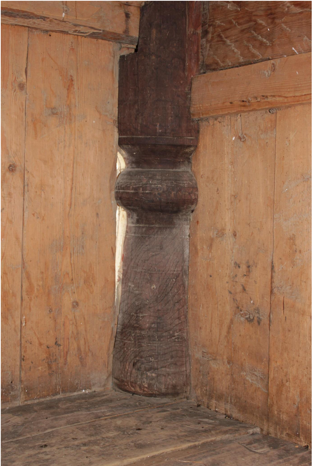
Figur 13. Skjønne, Søre. Nørdøstre svalstolpe i 2. etasje. Denne, og de andre stolpene i 2. etasje har samme type lasur. I nedre del er lasuren nesten helt slitt av på grunn av vask. Foto. J. Brønne. September 2017.
