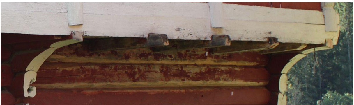
Figur 24. Skjønne, Søre. Detalj av nordveggen med skader i malinglagene som skyldes saltutslag. Foto. J. Brønne. September 2017.
