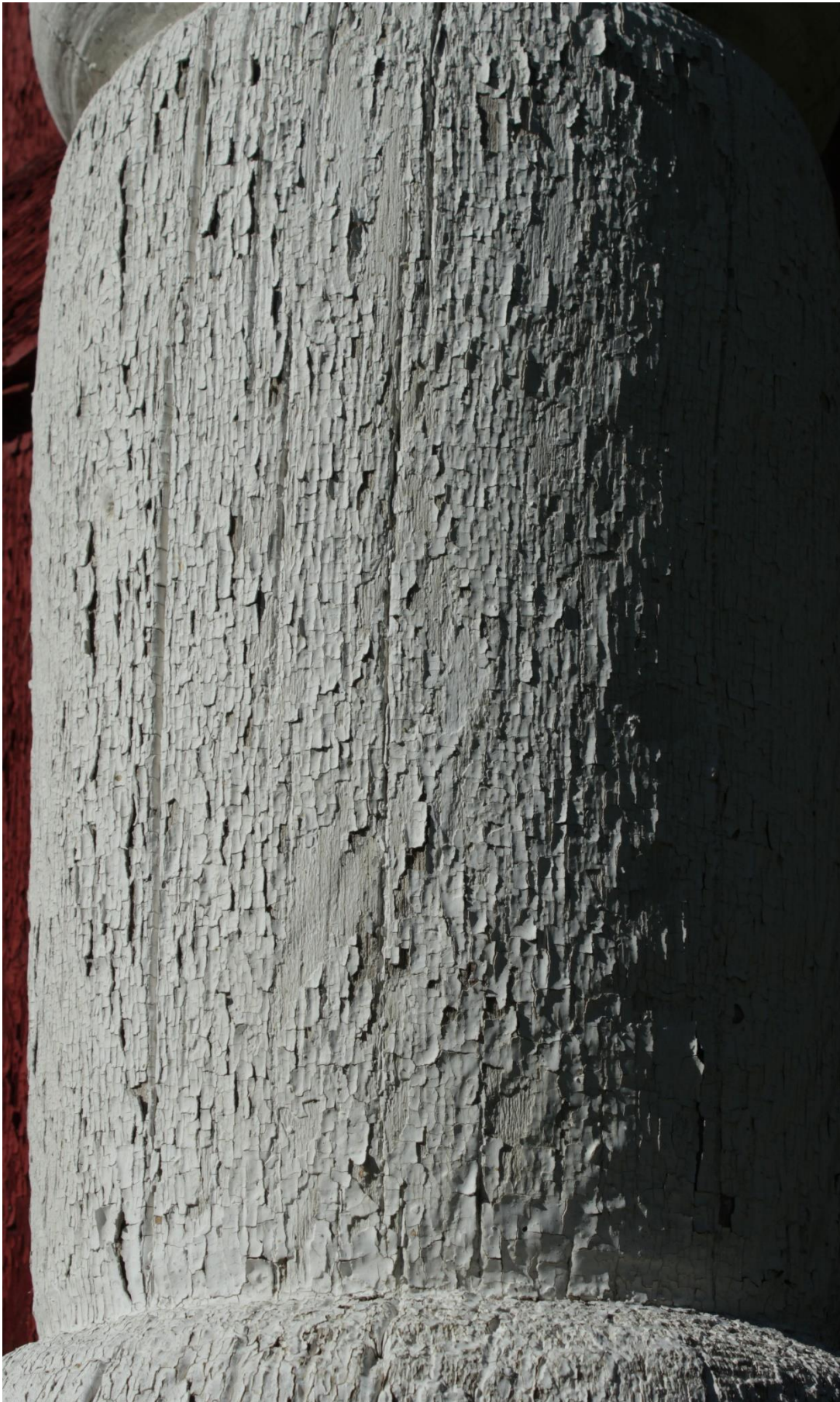
Figur 25. Skjønne, Søre. Detalj av Sydøstre svalstolpe med store opp- og avskallinger i malinglagene. Legg merke til at på denne svalstolpen er det kun hvite malinglag. Flere av de øvrige svalstolpene ble undersøkt, og det ble noen steder funnet rester av rød maling, som undertegnede mener er søl fra de røde malinglagene. (Se også figur 11) Foto. J. Brønne. September 2017.
