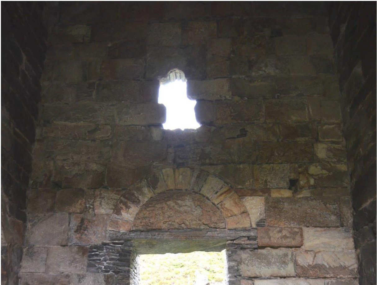
Figur 16: 30.5.2016: Fortsatt en del fukt, til tross for vårlig tørke. Mye fuktigere her nede enn oppover.
