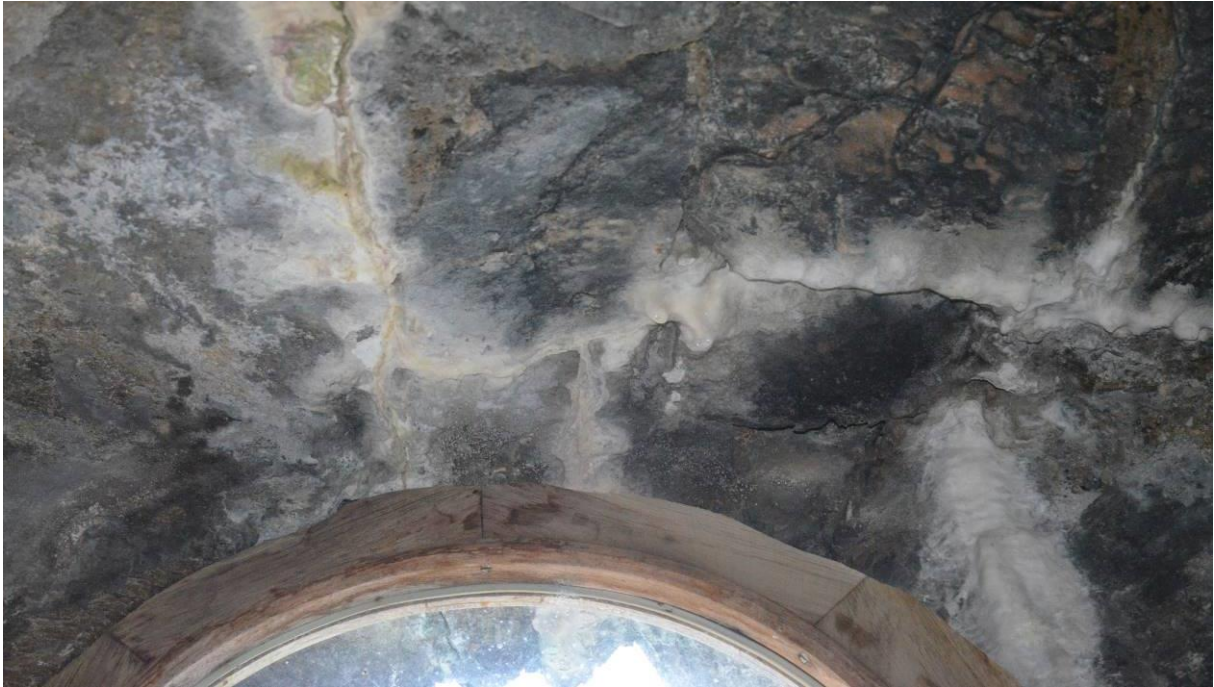
Figur 20: Det er vanlig å observere kalkskorper ( \text{CaCO}_3 ) i vindusbuer og ellers i murverket. Slike skorper er typisk et resultat av tidligere restaurering med sement og påfølgende vannlekkasjer. De bidrar i liten grad til forvitring av stein, men er en indikasjon på tidligere eller nåværende lekkasjer.
