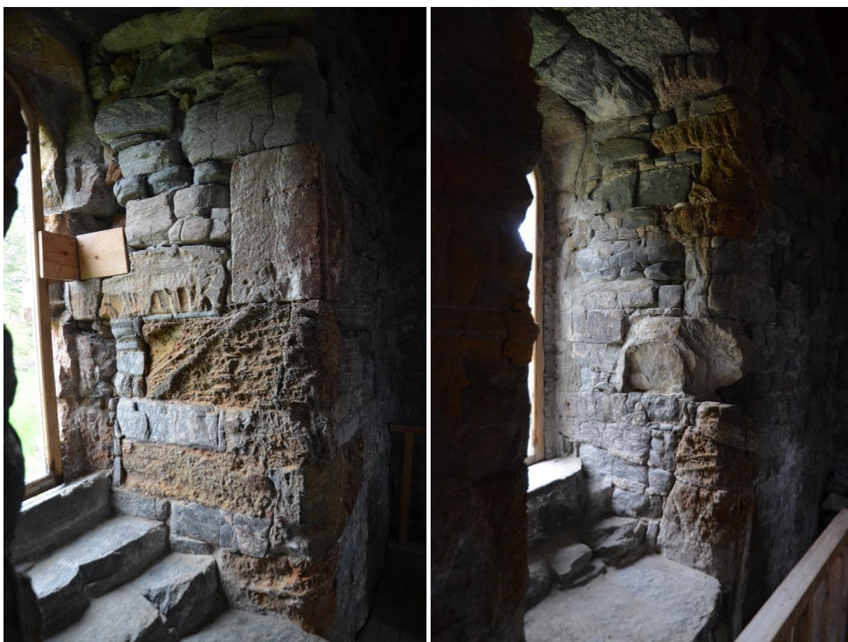
Figur 7: Vindusmyg i klokkeetasjen. Til venstre det østre vinduet, til høyre det søndre. Det er kun materiale fra den høyre siden av hvert vindusmyg som har blitt samlet opp; bare den ene halvdel av hver vindusbank ble med andre ord feid.
