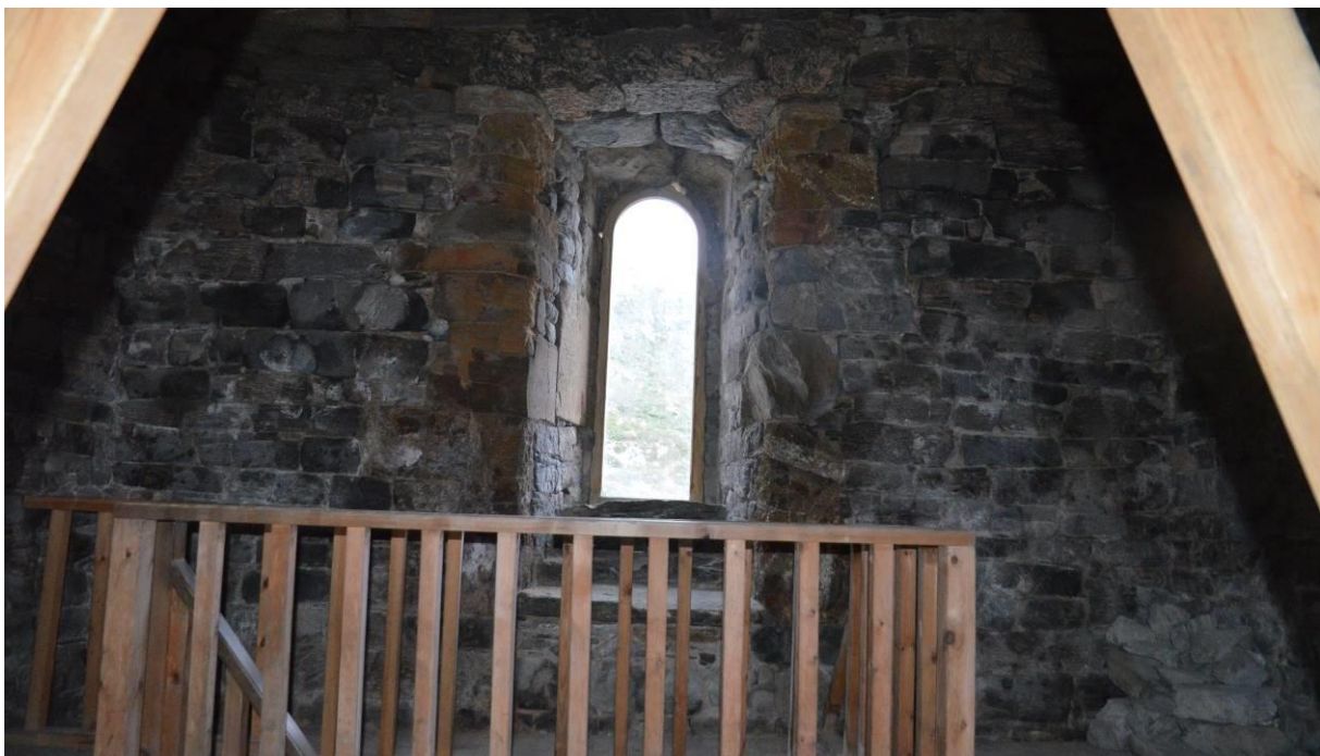
Figur 10: Sørveggen i klokkeetasjen, 12.1.2016. Alt er svært fuktig
