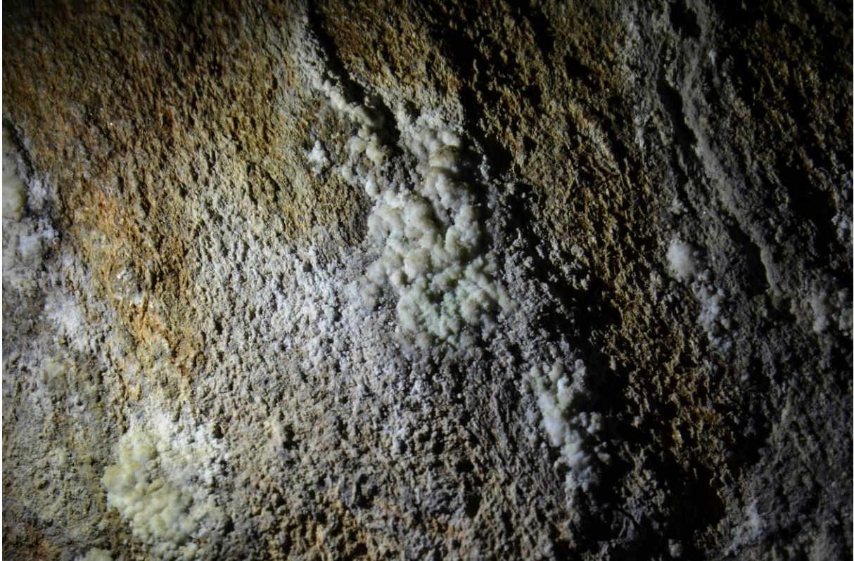
Figur 24: Gipsskorper på metaolivinstein i den øvre etasjen. Dette er et vanlig fenomen i tårnet. Gipsskorpene ( \text{CaSO}_4 \cdot 2\text{H}_2\text{O} ) kommer nok fra reaksjon mellom sulfat i metaolivinstein og kalk (Ca) fra kalkmørtel).
