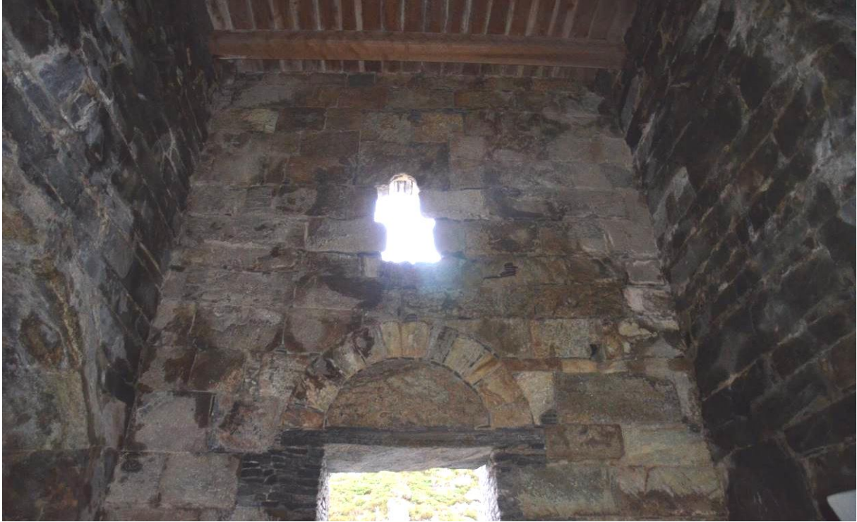
Figur 15: Østveggen i nederste etasje, 12.1.2016: Svært fuktig, spesielt på de tilgrensende veggene.
