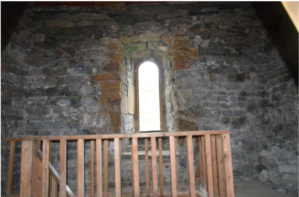
Figur 12: 14.9.2016: En god del fuktflekker. Spesielt i hjørner. Det var nokså fuktig på sensommeren.
