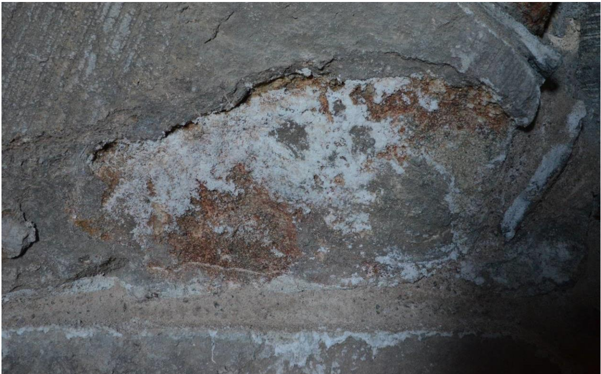
Figur 25: Salt i den midtre etasjen, ved den restaurerte «trekanten» på nordveggen. Saltene er ikke nøyaktig analysert, men det dreier seg om sulfater, trolig natriumsulfat. Mulig reaksjon mellom salt i mørtel og stein.
