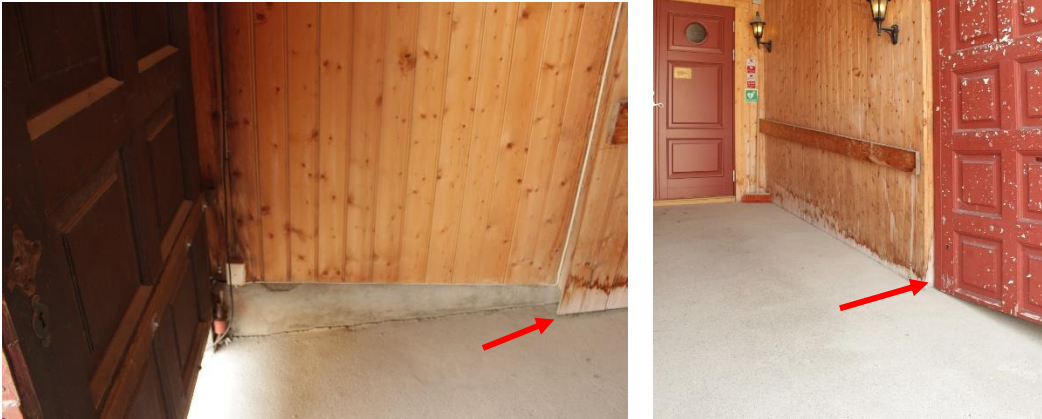
Figur 3. Røros. Bergmannsgata 19. Portrommet. De røde pilene markerer avslutningen på fotlistene mot vest, på nordveggen til venstre og sydveggen til høyre. Foto: J. Brønne 14.6.2017.
