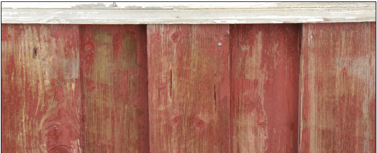
Figur 1. Røros. Vognbua. Område med skrapet panel. På grunn av slitasjen i overflatene av treverket har det blitt noe oppflising av trefibre i overflaten. Foto: J. Brønne. 12.6.2017.
