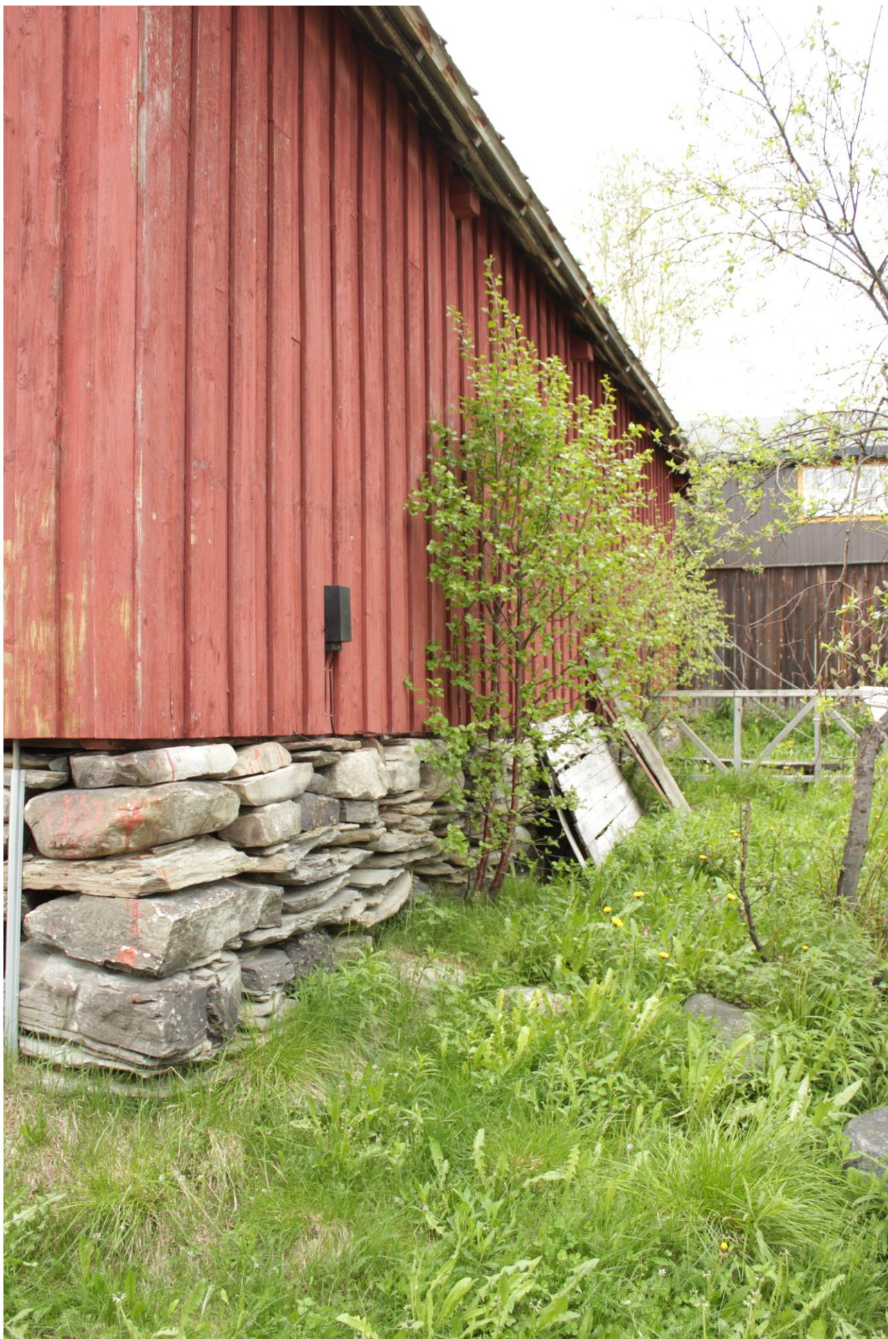
Figur 8. Røros. Vognbua. Sett fra sydøst med vegetasjonen som vokser inntil husveggen. Foto: J. Brønne. 12.6.2017.
