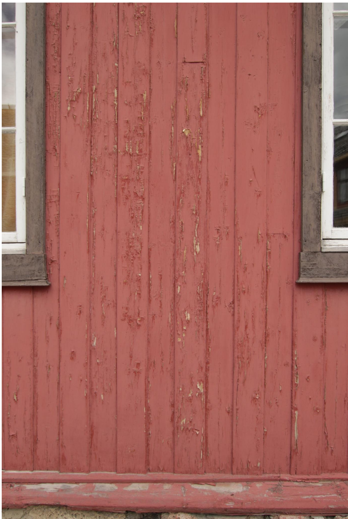
Figur 6. Røros. Flanderborg 5. Porten. Malingsskader på panelet. Foto: J. Brønne. 8.7.2016.
