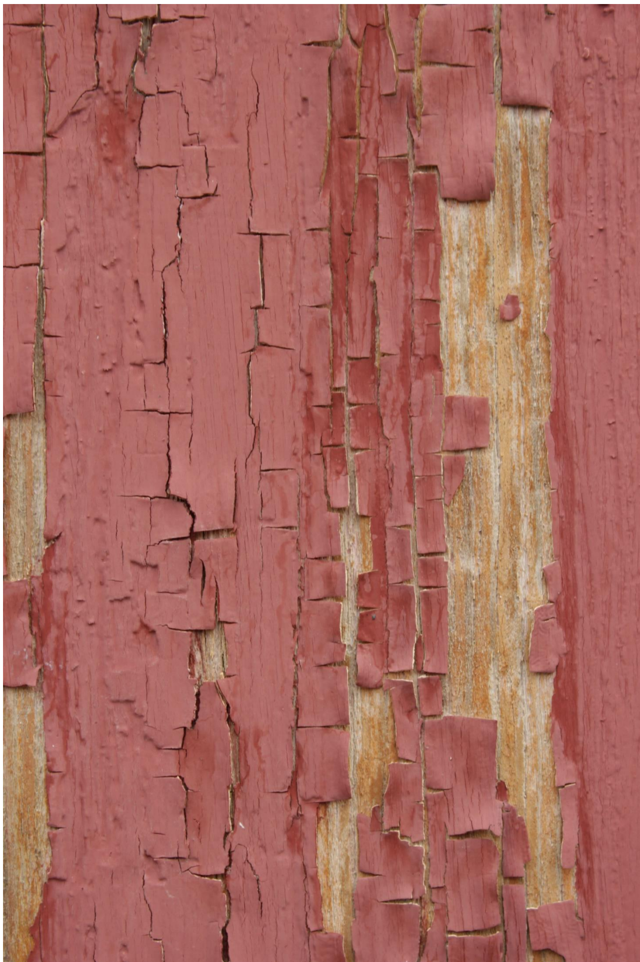
Figur 7. Røros. Flanderborg 5. Detalj av malingsskadene på panelet. I de avskallete partiene sees tydelig rester etter den gule oker oljegrunden som er årsaken til skadene. Foto: J. Brønne. 8.7.2016.
