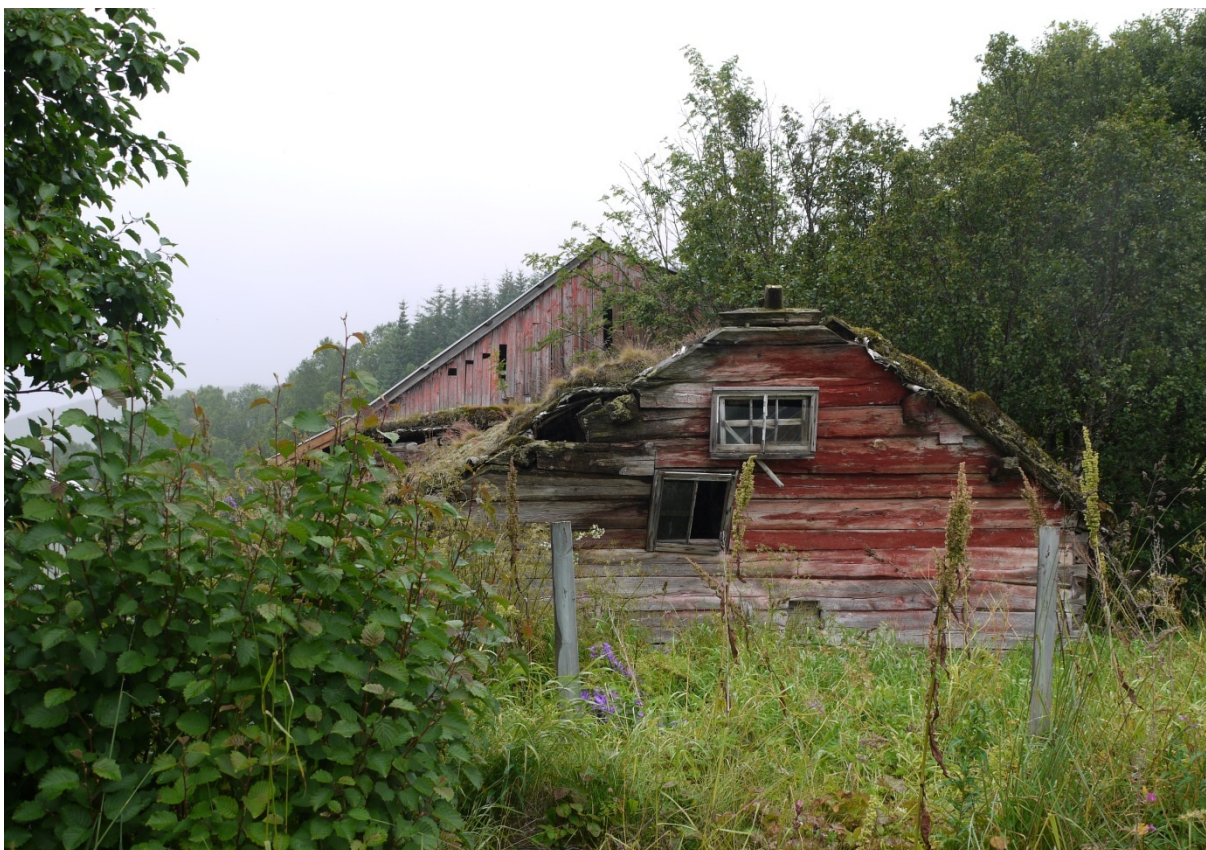
11 % av de gjenstående SEFRAK-bygningene eldre enn 1900 i Tromsø kommune er registrert som truet/sterkt truet. Forfall på stående bygninger representerer et potensielt fremtidig tap. Foto (19024001009): ÅD/NIKU 2016
