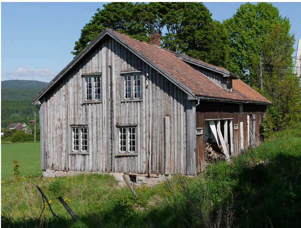
10 % av de kontrollerte SEFRAK-bygningene i Nittedal er registrert som truet/sterkt truet. Forfall på stående bygninger representerer et potensielt fremtidig tap. Foto (02330005015): ÅD/NIKU 2016
