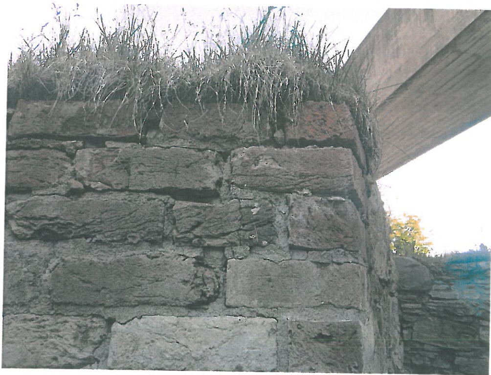
Sterk forvitring av teglsteinen i østre vindusnisje. Vann fra toppdekket trenger ned i muren
