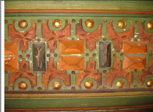
Avskallinger på arkitekturelement på prekestol
