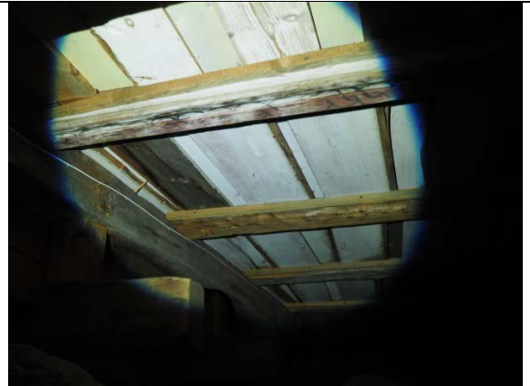
Bilde tatt i krypgrunn. En av gulvbjelkene er bemalt med 1600-tallsdekor og er trolig gjenbruk fra interiøret.
