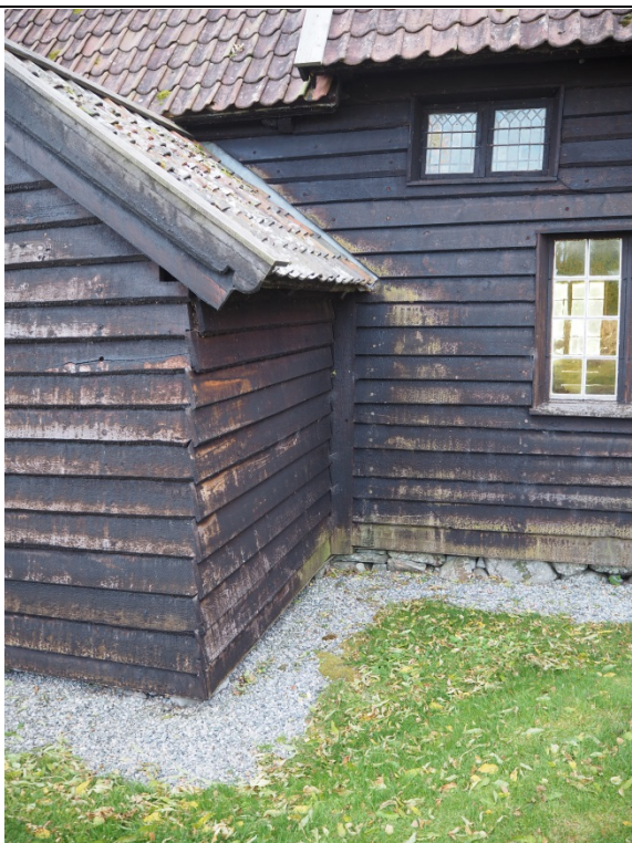
Sakristi og skip i nord. Tegn på alge- og mosevekst på den nedre bordene, trolig fordi det ikke finnes takrenne og nedløpsrør.
