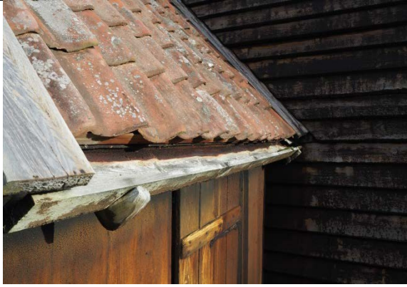
Takrenne og dekkbord ved overgang våpenhus og skip. Liten helling på takrenne gjør at det blir unødvendig stort fuktpåslag på kledning.
