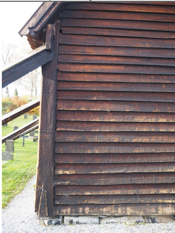
Søndre halvdel av korets østvegg. Kirkens grunnmur er ikke høy, men grusgang og tilstrekkelig vinkel på nederste bord gjør at konstruksjonen her holdes noenlunde tørr.
