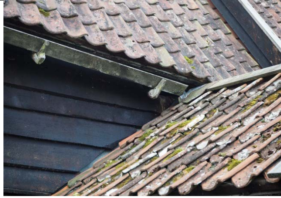
Overgang mellom sakristi og kor i nord. Det er lagt blikk over møne slik at vann fra takrenne på koret skal ledes ned på taksteinen. Punktet bør overvåkes og taksteinene renses for mose.
