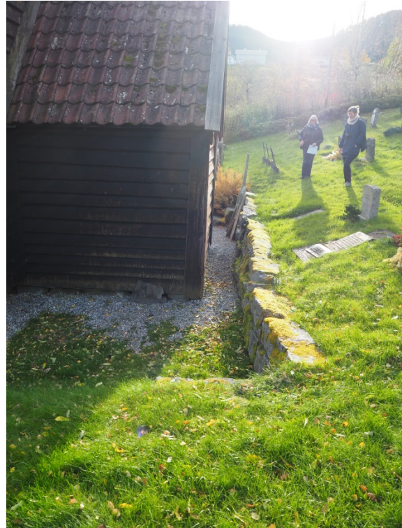
Våpenhuset i nord svært tett i forhold til forstøtningsmuren opp mot kirkegården i vest. Med større fuktbelastning vil det bli et problematisk punkt.
