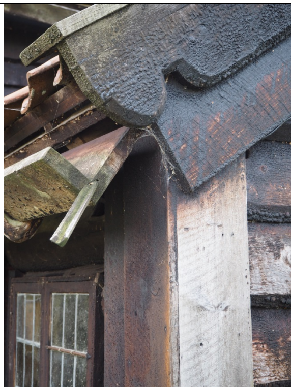
Sakristi, nordøstre hjørne. En enkel løsning med forlengelse av takrenne fører vannet lenger ut fra bygningskroppen.
