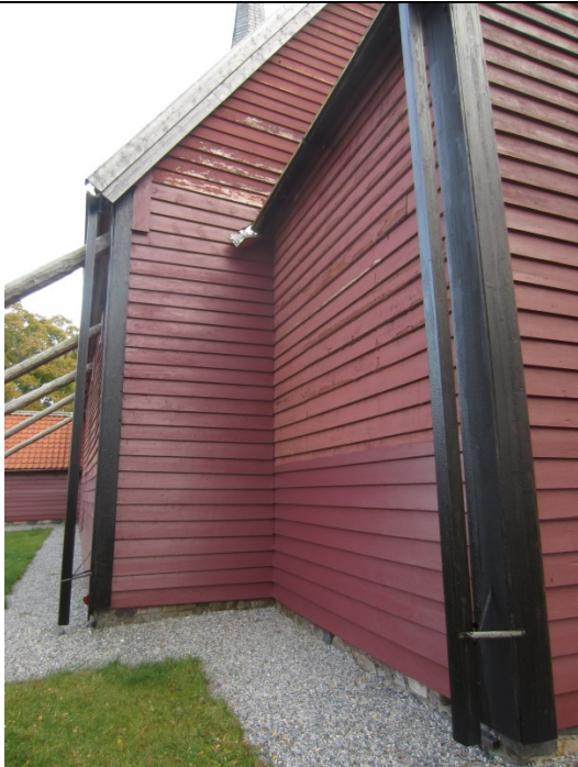
Kritisk hjørne mellom skipet og dåpshuset. Gradrennens korte utstikk har årsaket stor fuktpåslag på fasaden.
