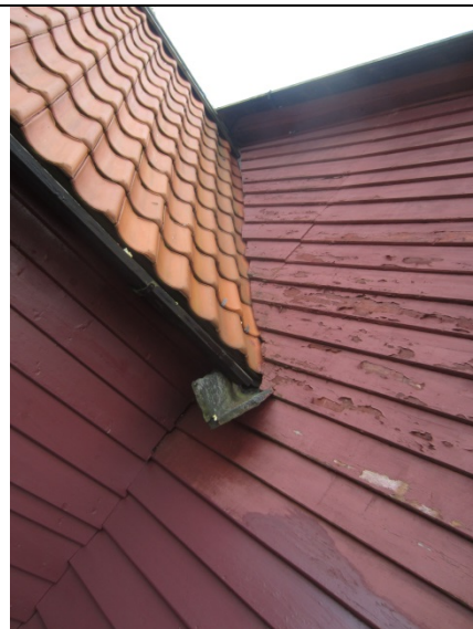
Nordvegg, sakristi til venstre. Nedre del av panelet er nymalt. En liten takrenne før ut vann vekk fra fasaden.
