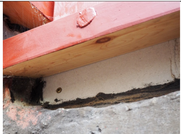
Detaljbilde av sokkel-list og brannhemmende plater bak. Kirka er i dag meget tett.
