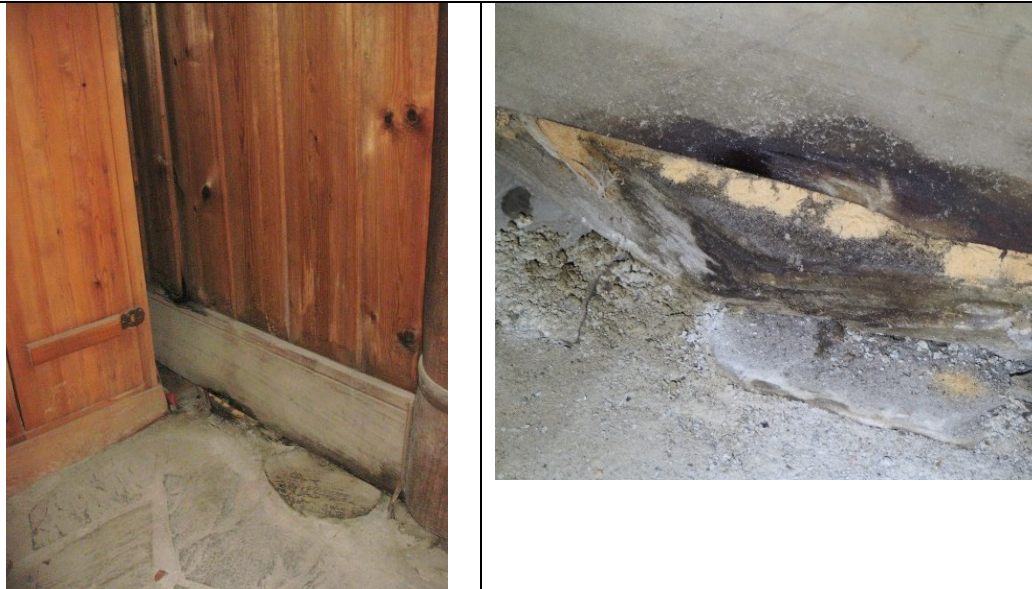
På innsida av nordre omgangens østre hjørne ble det registrert boremel, se detaljbilde til venstre, og tegn på fuktbelastning.
