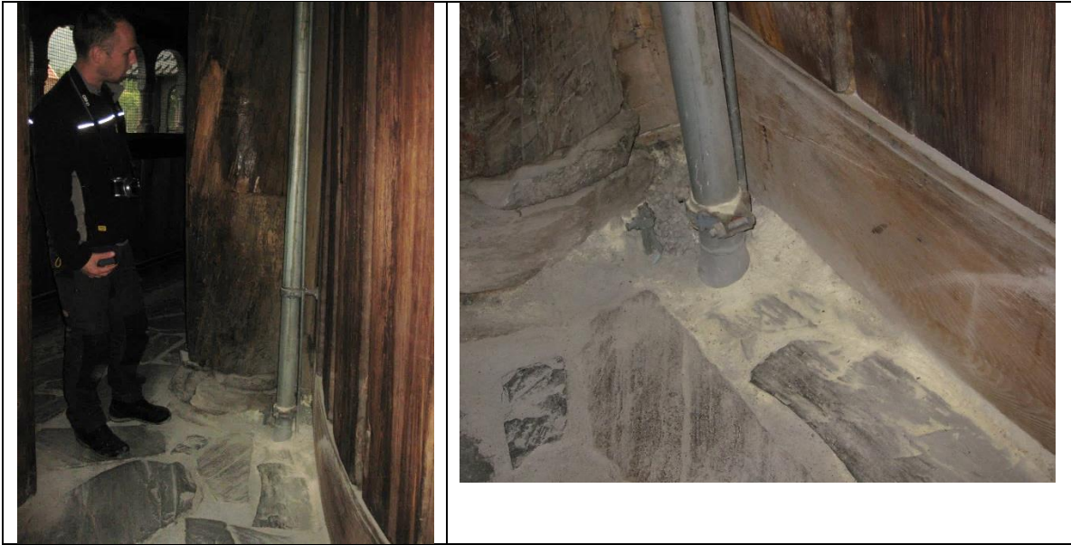
Rørssystem for sentralisert brannslukkingssystem står tett inntill hjørnestolpe. «Melet» som ble registrert, se detaljbilde til høyre, er av ukjent art og bøl, hvis det fortsetter å samles, undersøkes videre.
