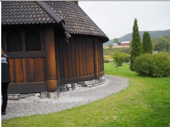
Sydsida av apsidens grunnmur. Noter linjen i grusgangen som dannes takke være taktspringet. Dybden gikk igjenn rundt hele kirka.
