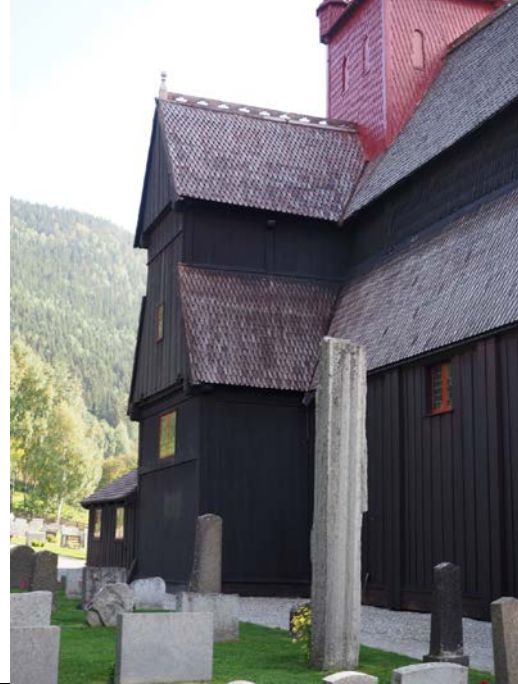
Tak med tydelig større behov for tjærebreng enn ytterveggene på nordsida.
