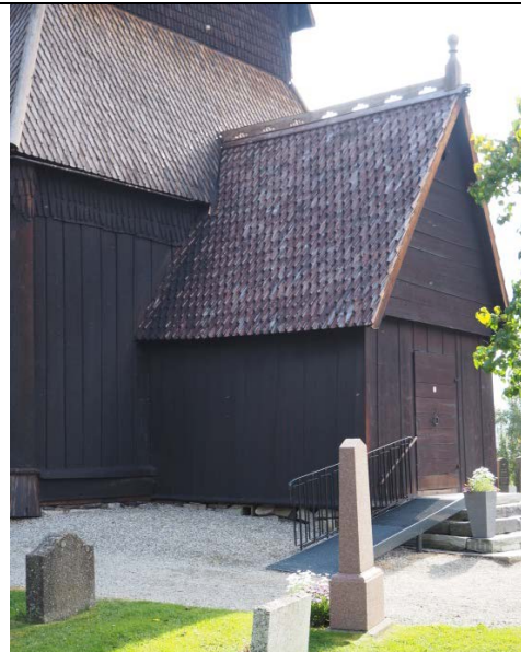
Ryttere, våpenhus, stensatt trapp og rampe sett fra nordvest. Legg merke til slitasje på våpenhusets takfall under skipet, her finnes ikke takrenne. Forholdvis godt fall ut fra grunnmur og krypekjeller.
