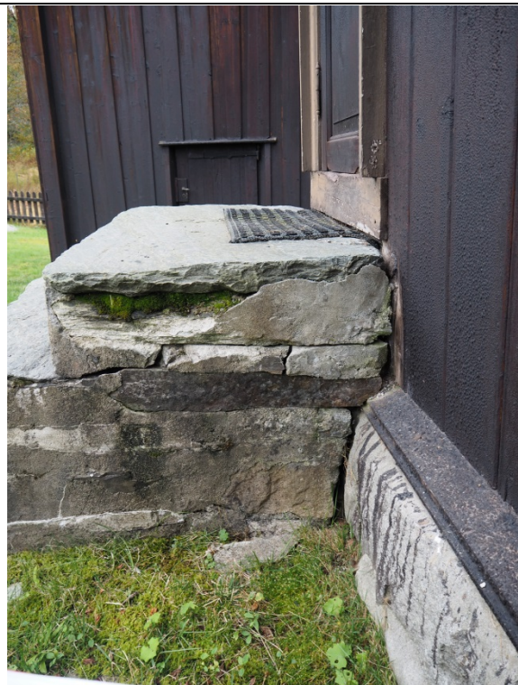
Detalj bilde av steintrappen opp til sakristiet. Den sementholdige pussen er skadet og mose har begynt å gro i fuger og hulrom.
