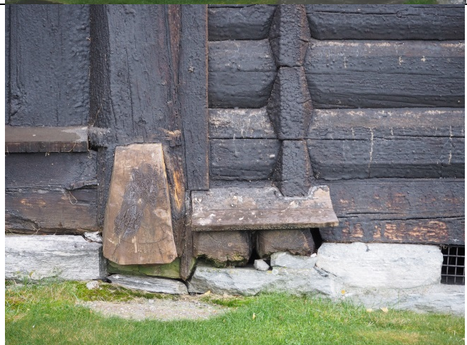
Overgang mellom stakonstruksjon og laft på nordre side av langskip. Nederst viser endetre tegn på algevekst.
