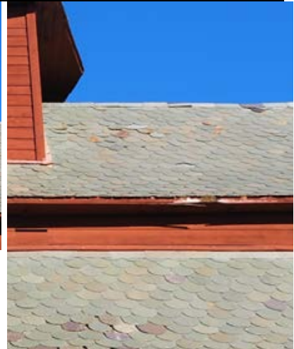
Detalj, lysere område i front av gesims er vannskade
