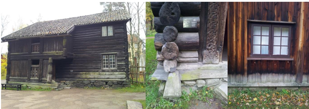
Synlige tegn på fuktbelastningene på de deler av veggene som er mest utsatt for fuktbelastning ved nedbør – slagregn og sprut opp fra bakken. Foto: Marte Boro © Riksantikvaren.
