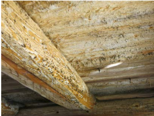
Foto 1. Overflatisk nedbrytning av treverk kan skyldes mange årsaker. På undersiden av stabbur kan det være saltsøl fra tidligere bruk.
