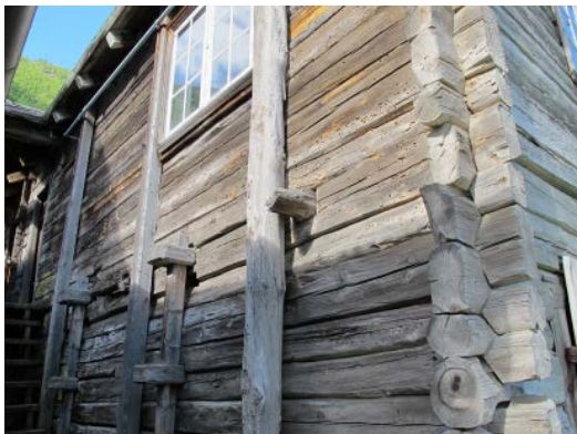
Foto 3. Husbukgangrep i kun øvre del av en vegg kan være vanskelig å forklare inntil man ser hvilke materialer som blir soloppvarmet og dermed gunstige for larveutvikling.
