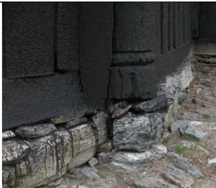
Stav på overgang korvegg-apsis nordside.
