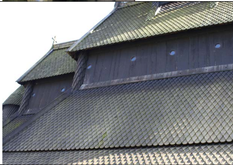
«Grønske» - algevekst på takflater på absiden og på norddelen av taket. Veksten bør vurderes fjernet.
